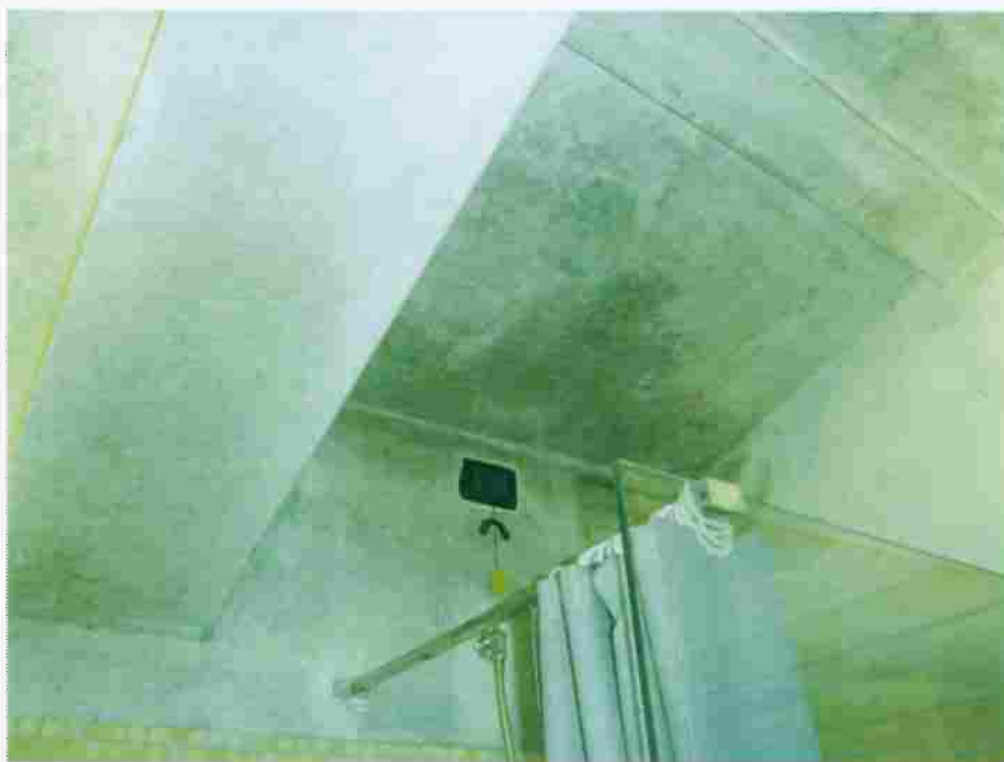
Foto n° 46 – Bagno; vista delle tracce di umidità nel soffitto.
