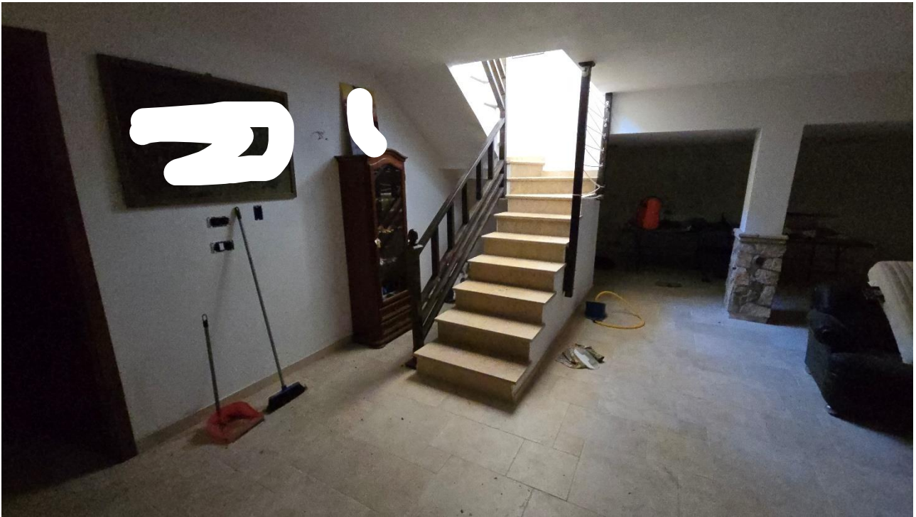
Fig. 22 – Cantina (vista verso ampliamento abusivo sotto al portico)
