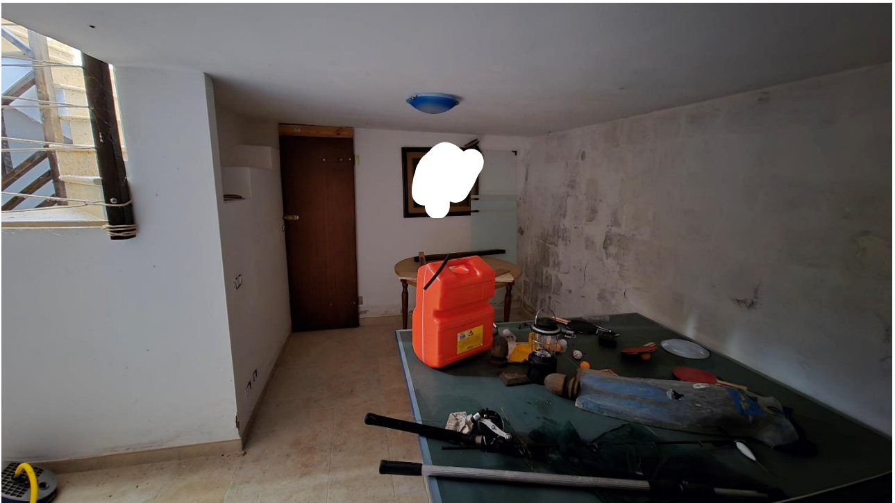
Fig. 23 – Parte di ampliamento abusivo della cantina
