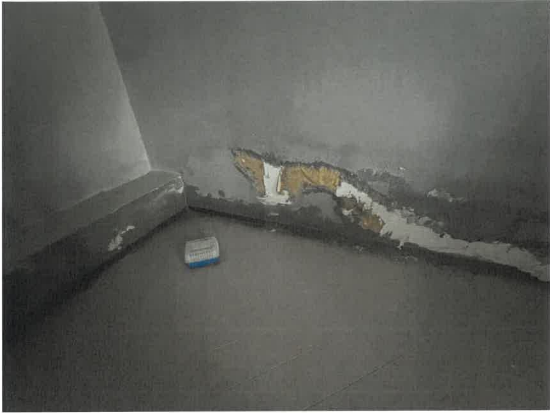
Figura 11 umidità da risalita al PT
