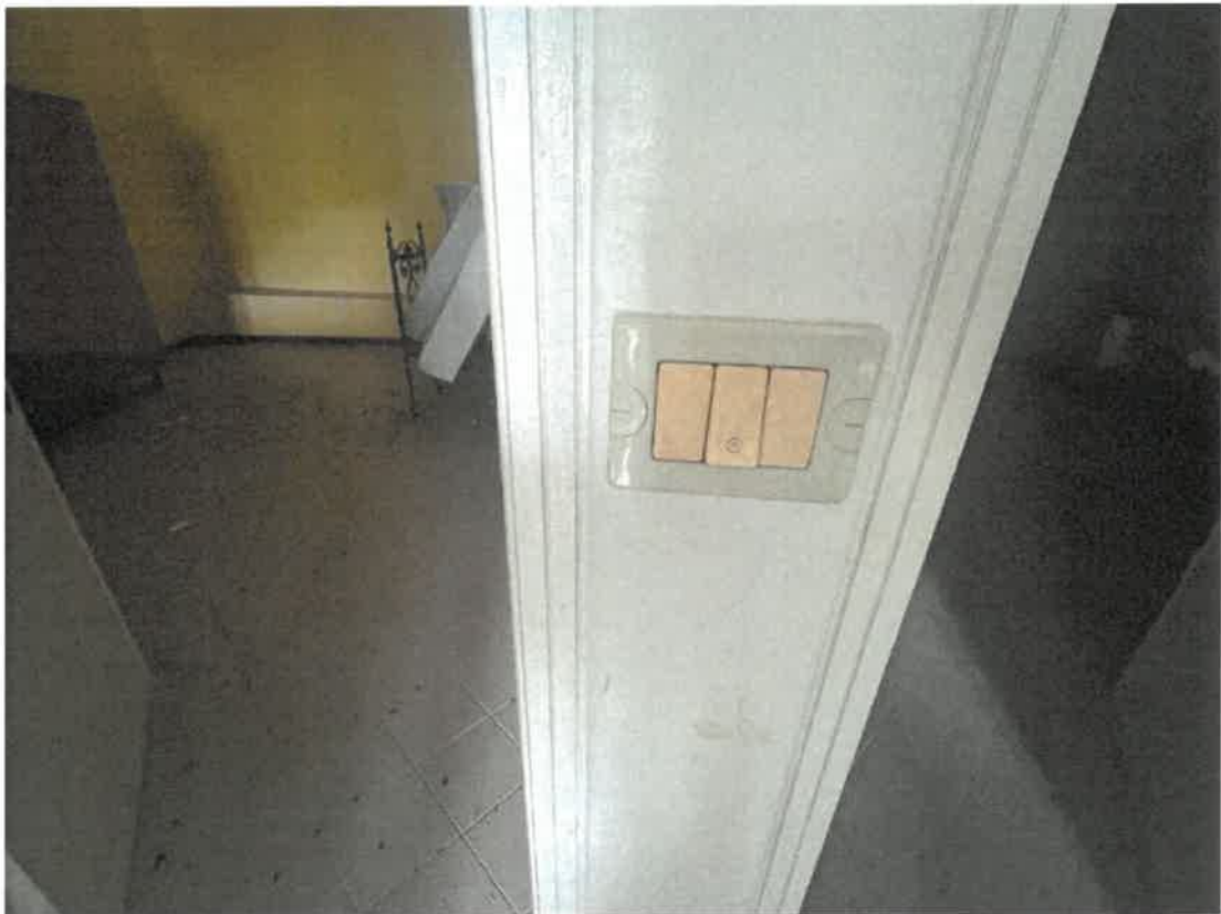
Figura 10 dettaglio impianto elettrico
