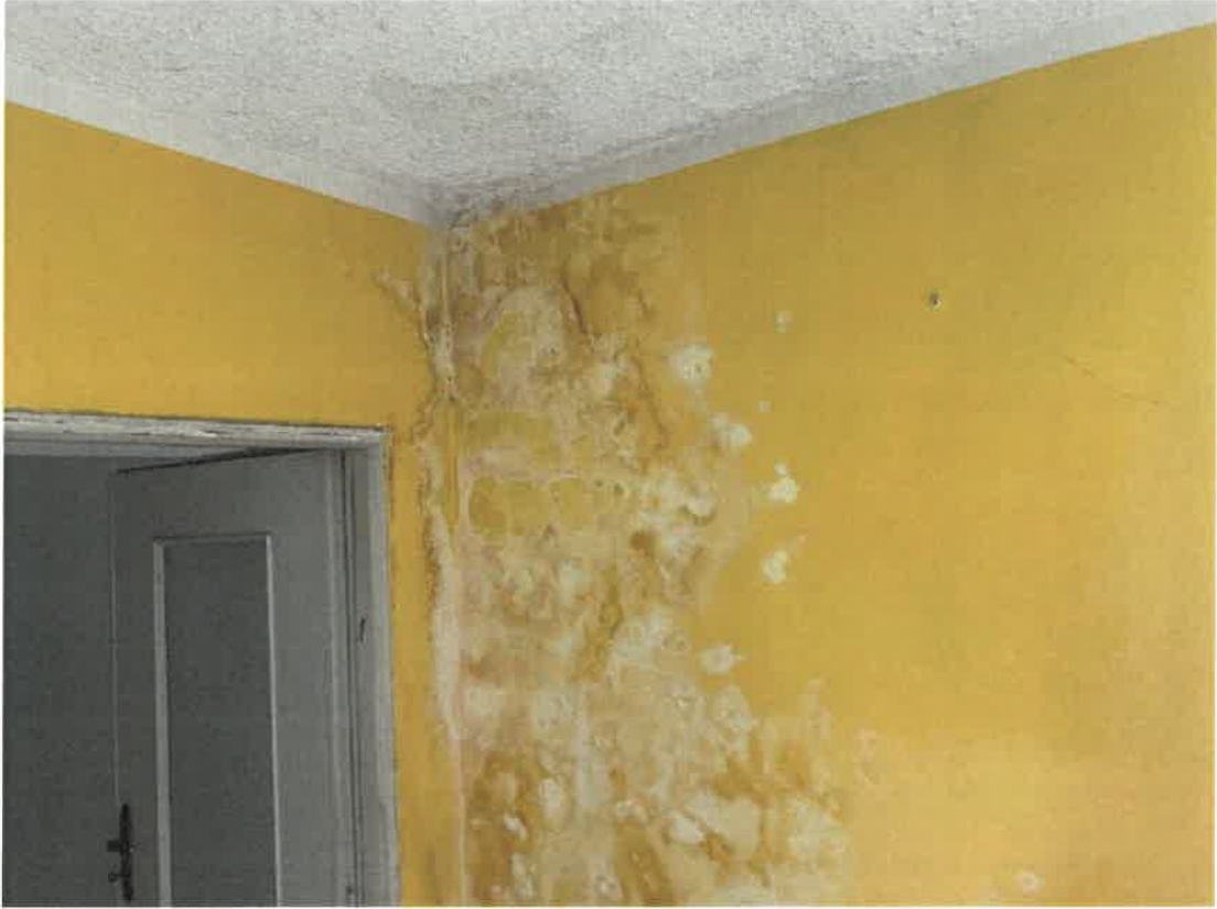
Figura 21 infiltrazioni dalla copertura al P1
