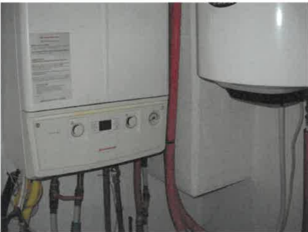
Caldaia alloggio piano terra Lotto 1
