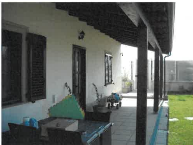
Porticato non autorizzato piano terra Lotto 1
