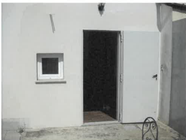
Vano ufficio non autorizzato piano terreno Lotto 1
