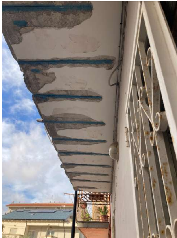
Foto n. 12: Immobile pignorato – particolare intradosso balcone superiore
