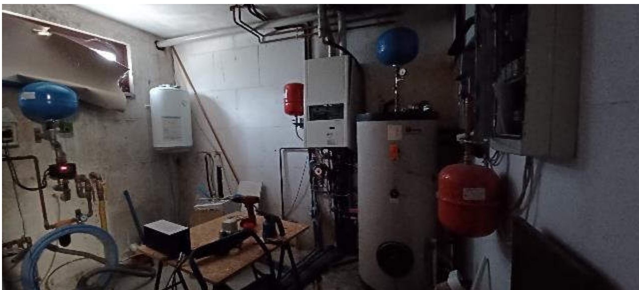
Foto n. 18. Piano seminterrato. Centrale termica
