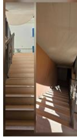
particolari delle scale di accesso: a salire e a scendere dalla u.i. pignorata
