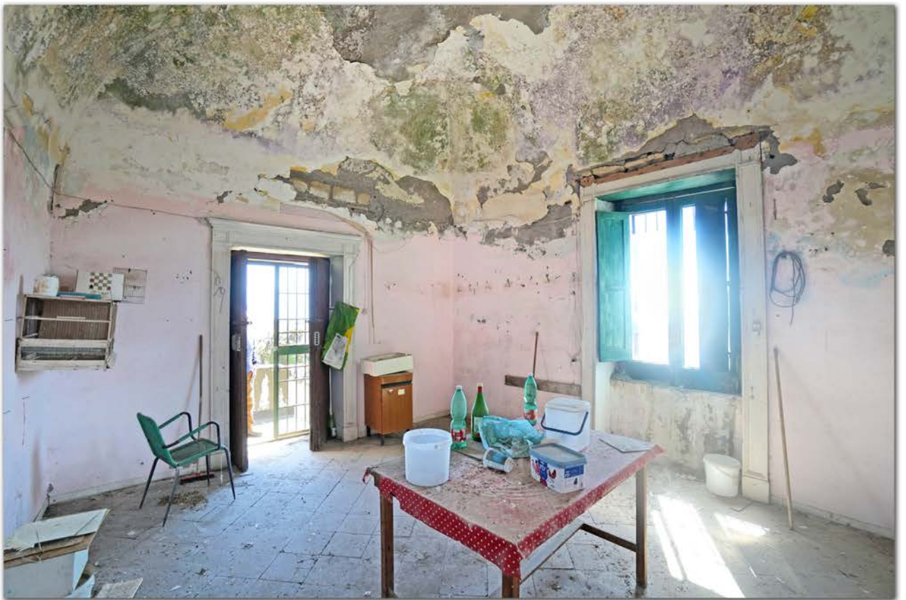
FOTO 13. Porzione di fabbricato colonico disposta su due livelli - Vano al primo piano.
