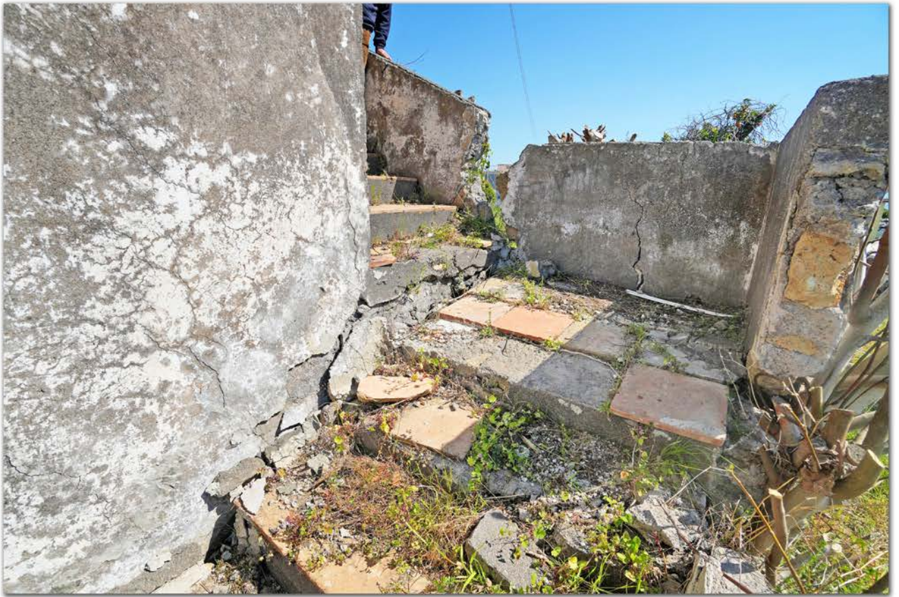
FOTO 11. Porzione di fabbricato colonico disposta su due livelli - Scala di accesso al primo piano in particolare stato di degrado.
