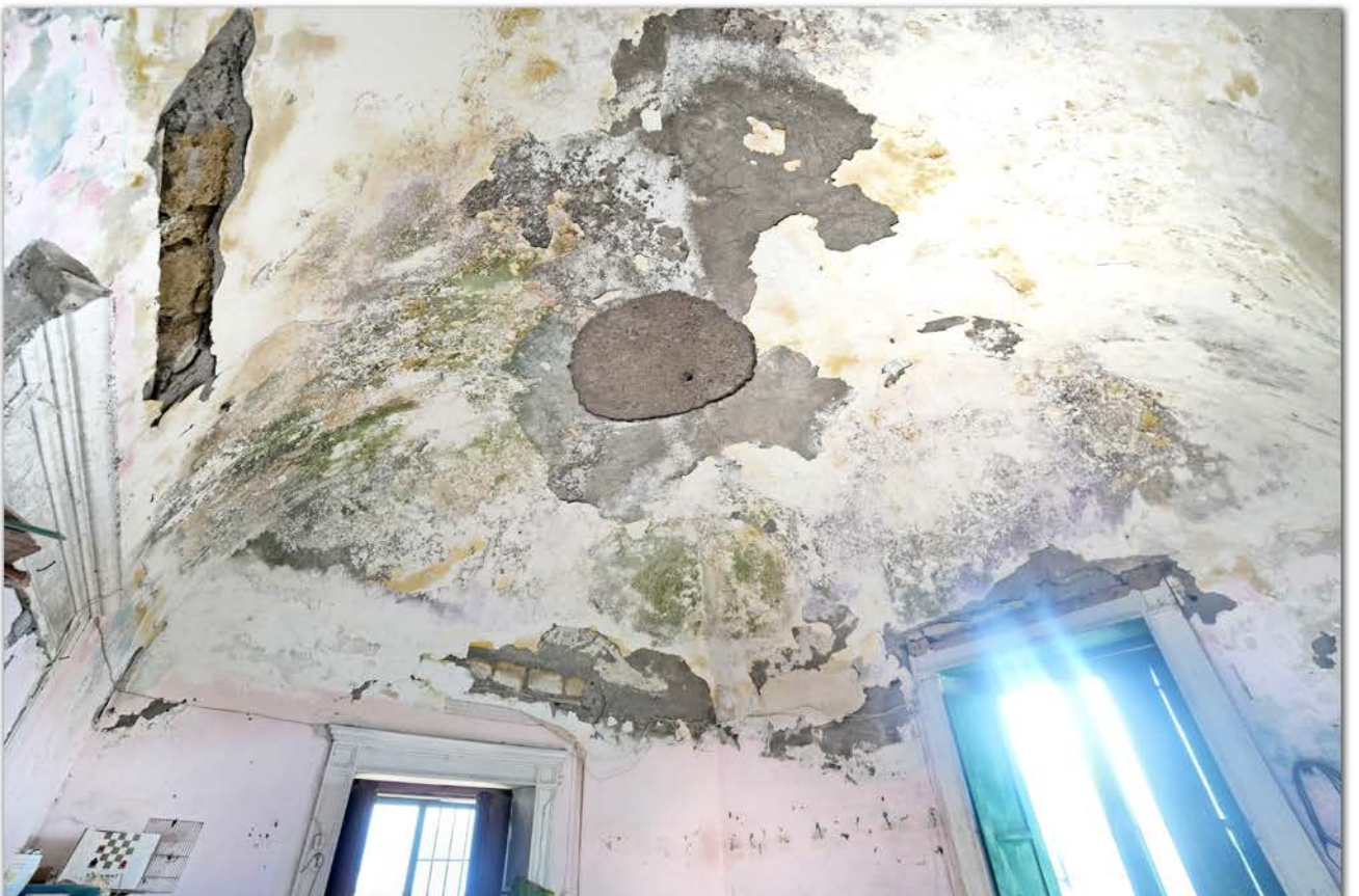
FOTO 14. Porzione di fabbricato colonico disposta su due livelli - Particolare copertura a volta, in avanzato stato di degrado.
