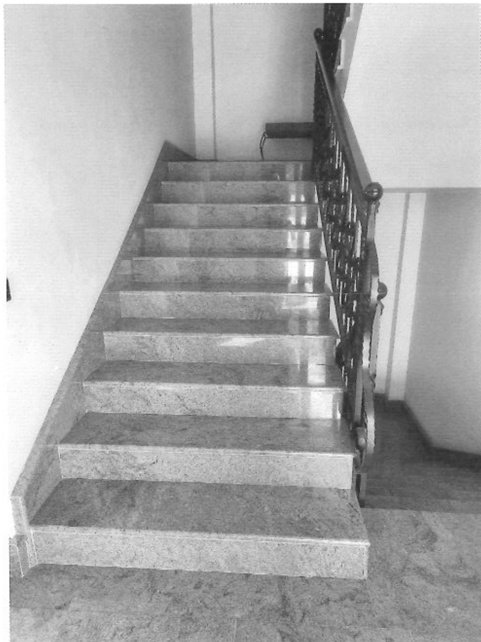
Foto N. 06 < Particolare: scala a doppia rampa in granito con ringhiera in ferro battuto - Stato eccellente - Alleg. N. 03 >
