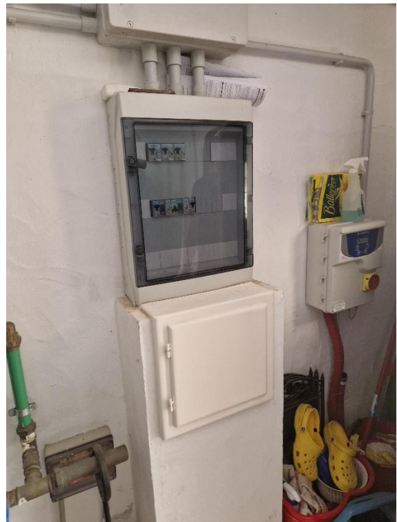
Locale tecnico seminterrato
