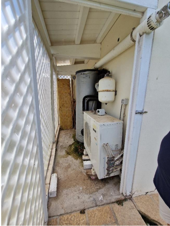
Locale tecnico sul retro
