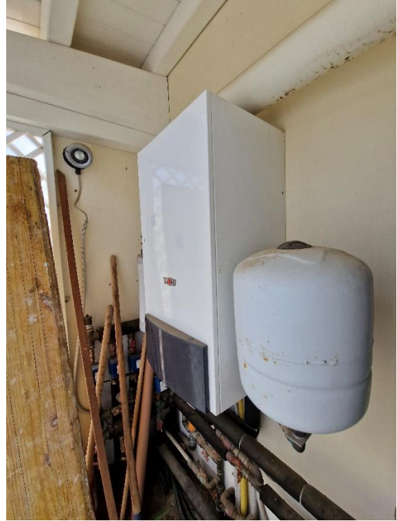
Locale tecnico sul retro
