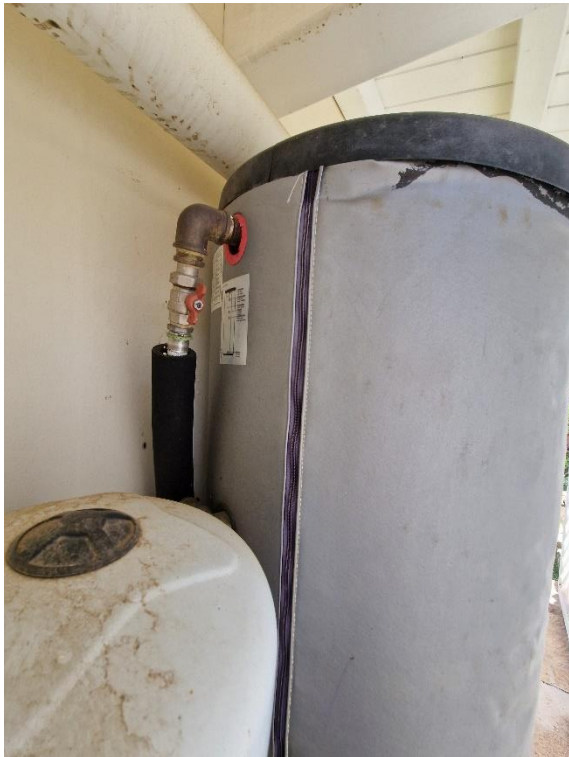
Locale tecnico sul retro
