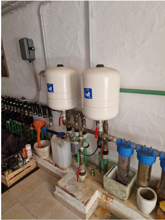
Locale tecnico seminterrato
