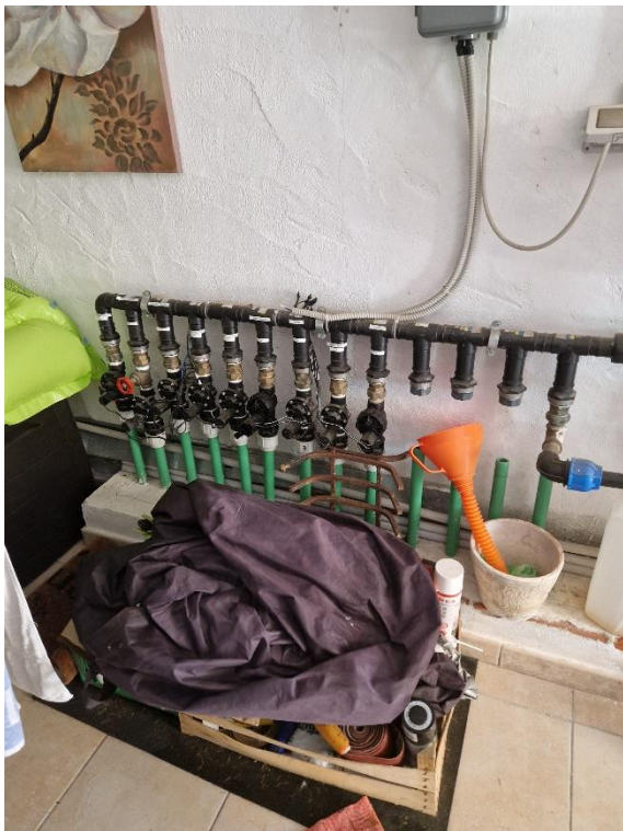
Locale tecnico seminterrato
