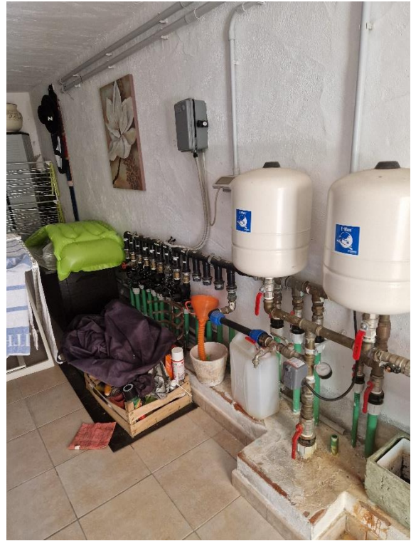
Locale tecnico seminterrato
