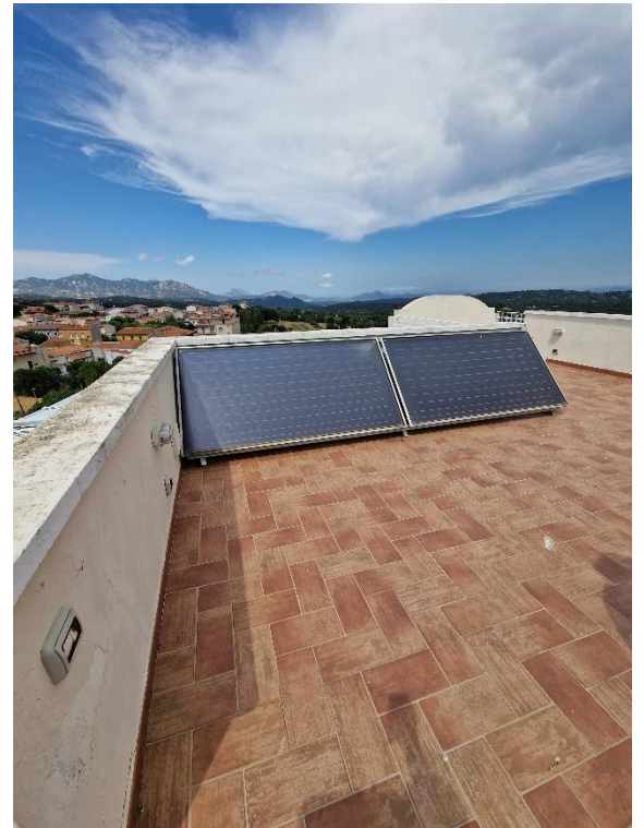
Pannelli solare termico
