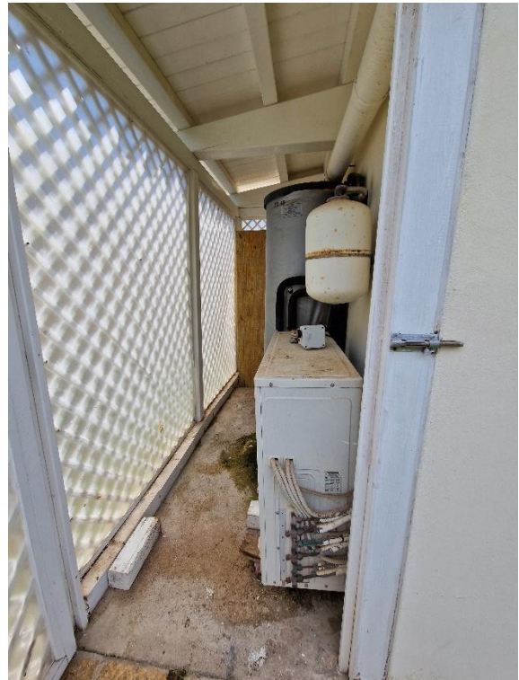
Locale tecnico sul retro
