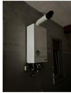
Foto 29 – Caldaia sul balcone
