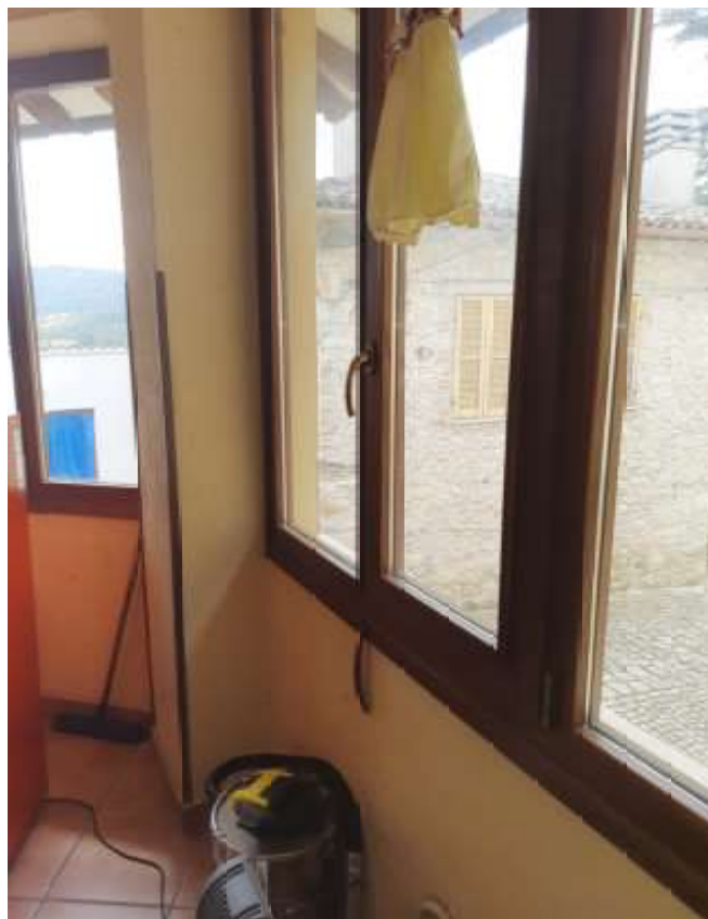
Foto n.7: Particolare della loggia con tamponatura in vetrate non autorizzata
