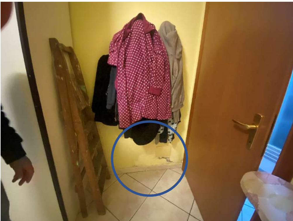
Foto 14: Vista segni di umidità
