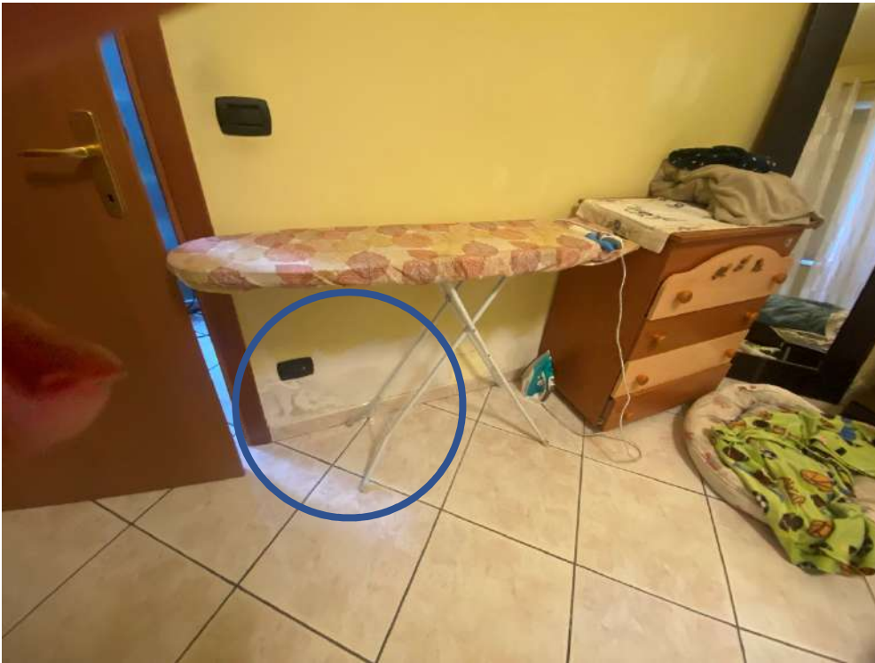
Foto 15: Vista segni di umidità
