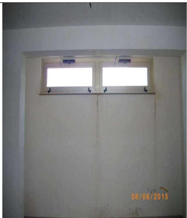
l'infisso a Vasistas , comune con l'altro sub. , si nota CHE NON C'E' muro di divisione tra i sub., inoltre si NOTA la parte Abusiva ( quella oltre il pilastro posto sul lato sinistro )
