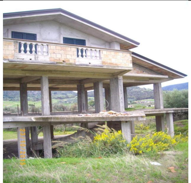
fronte nord- est : livello fuori terra del primo solaio, lato ingresso , visto da quota + 2.0 mt
