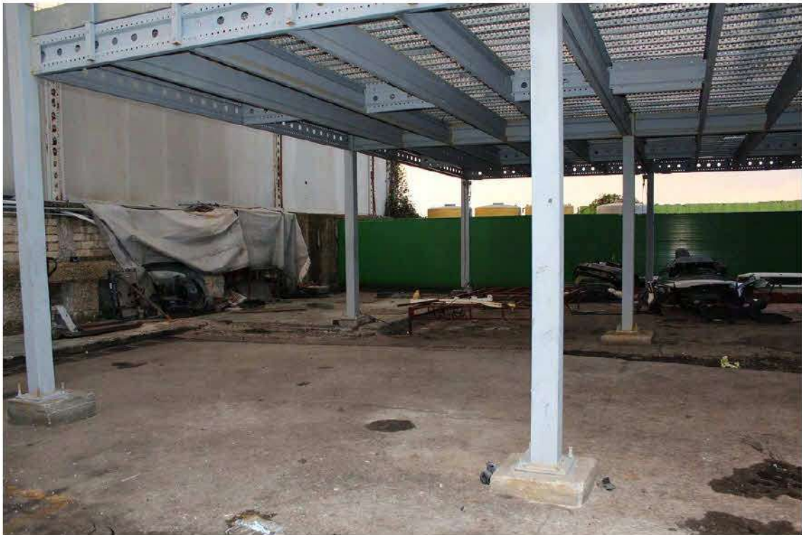
Foto 31: ancoraggi dei pilastri della scaffalatura Omissis dimensioni (10x20) m.
