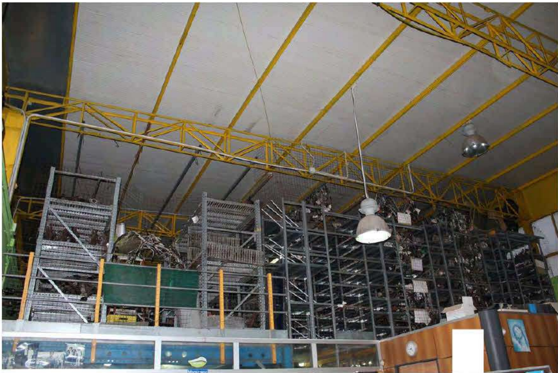
Foto 12: scaffalatura soppalcata a due piani per lo stoccaggio dei ricambi usati.
