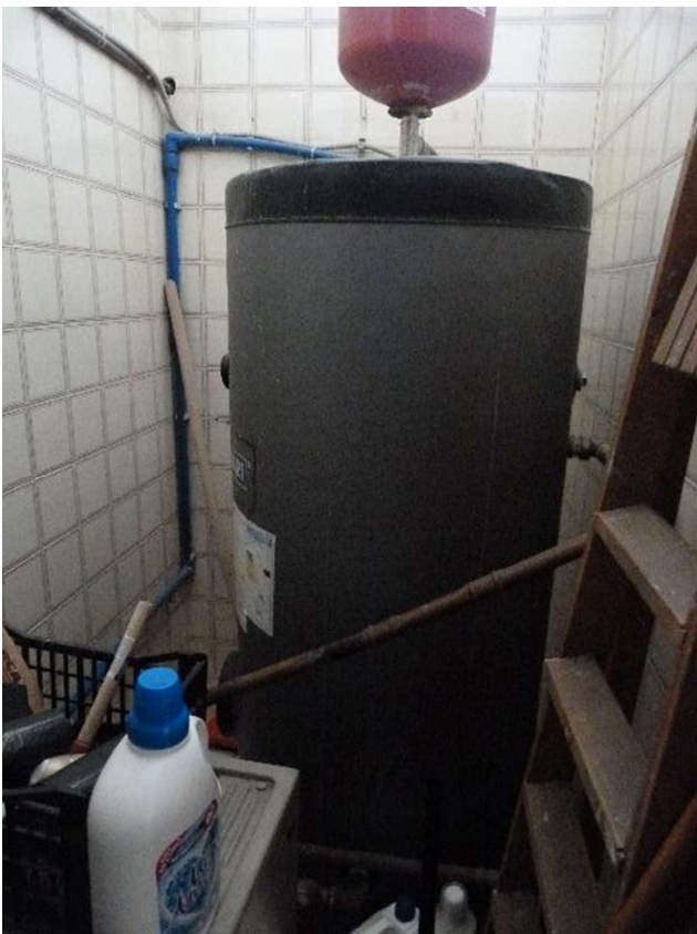
Accumulatore acqua calda nell'altro servizio
