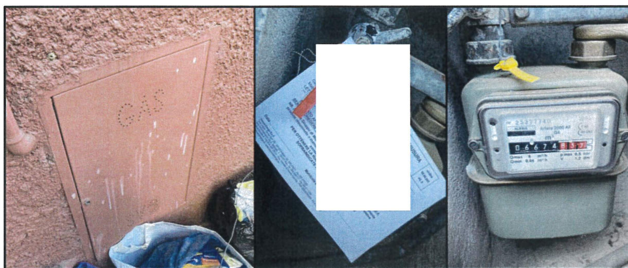
Impianto gas: alloggiamento contatore di fornitura
