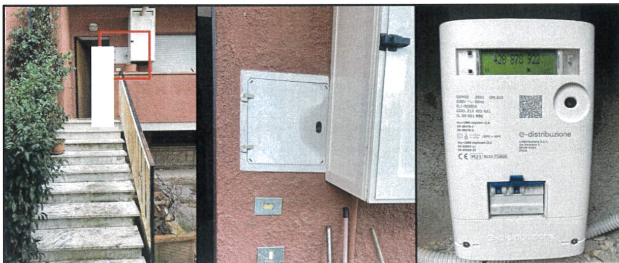
Impianto elettrico: punto di fornitura con alloggiamento contatore.
