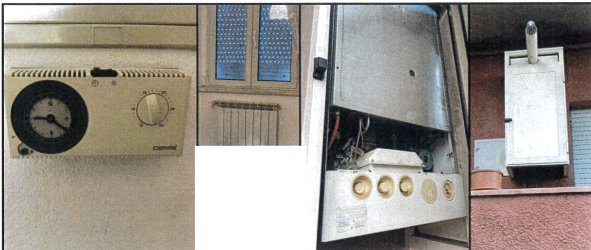
Impianto riscaldamento: termostato, radiatore, dettaglio caldaia
