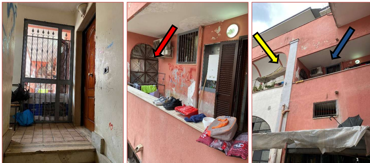
FIGURA 2. A SINISTRA: CANCELLO TRA IL PIANEROTTOLO E IL BALCONE (ORIGINARIO BALLATOIO). AL CENTRO: BALCONE (ORIGINARIO BALLATOIO) CON CANCELLO DI ACCESSO AD ALTRO IMMOBILE (INDICATO CON LA FRECCIA ROSSA). A DESTRA: BALCONE (ORIGINARIO BALLATOIO, INDICATO CON FRECCIA BLU) E IMMOBILE CONFINANTE (INDICATO CON FRECCIA GIALLA).
