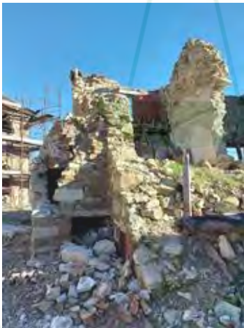
fabbricato collabente - prima della demolizione
