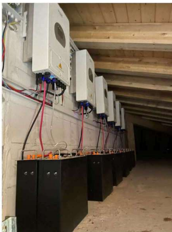
FOTO 5 – inverter e batterie di accumulo
