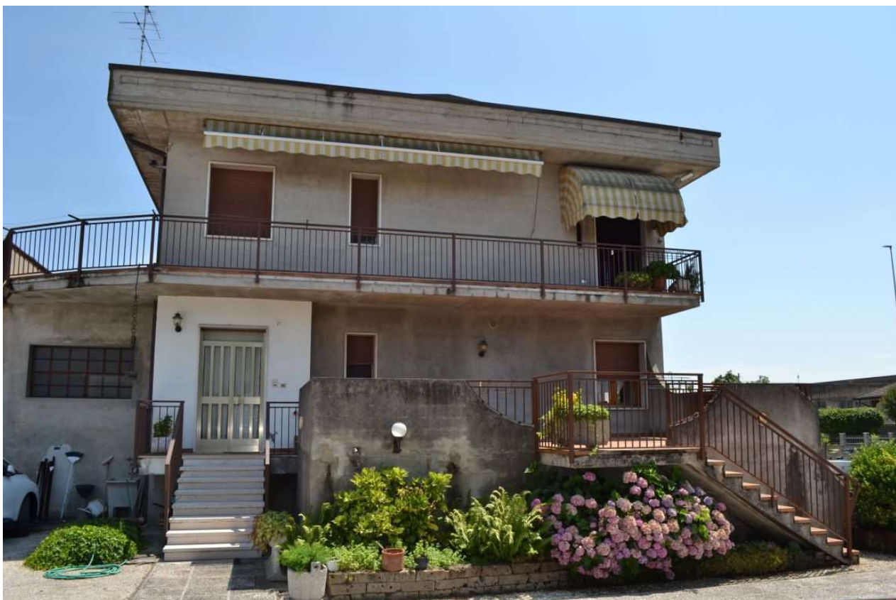
foto 9 – m.n. 93 (visto da ovest dalla corte interna sub 9) – L'unica parte visibilmente tinteggiata dell'involucro esterno è la porta d'ingresso del vano scala promiscuo, peraltro estraneo all'esecuzione. Anche la terrazza e le due gradinate scoperte visibili in foto non sono colpite da pignoramento. La finestra al centro è quella del bagno n. 2; quella a destra è dell'ufficio n. 1.
