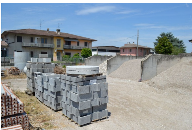
foto 12 - m.n. 428 (area urbana) - I muri di contenimento dell'inerte, ridossati sul confine nord, non sono indicati né al catasto né in Comune.
