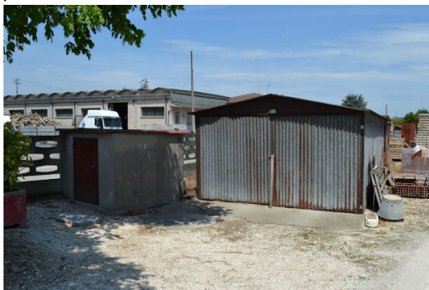
foto 4 - deposito delle bombole del gas bcnc sub 8 (a sinistra) e annesso accessorio baraccato in lamiera grecata (a destra). Del secondo fabbricato non si trova traccia né in Ufficio tecnico né al catasto
