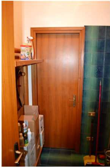
foto 4 - sub 1 (anti) - Piastrellature verticali solo parziali.
