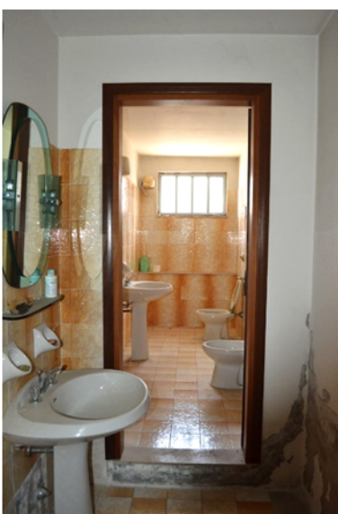
foto 16 - sub 4 (anti) - Primo lavabo; efflorescenze muffite.
