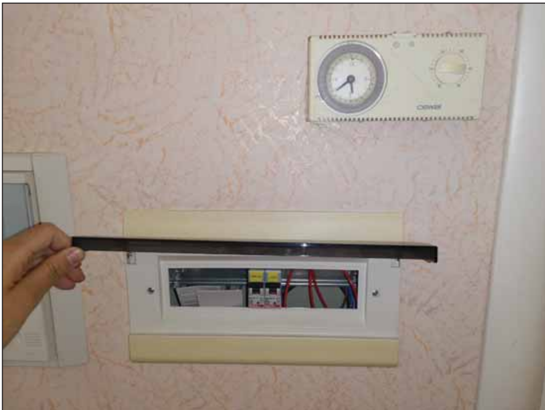
FOTO 70 - Piano secondo – Impianti.
