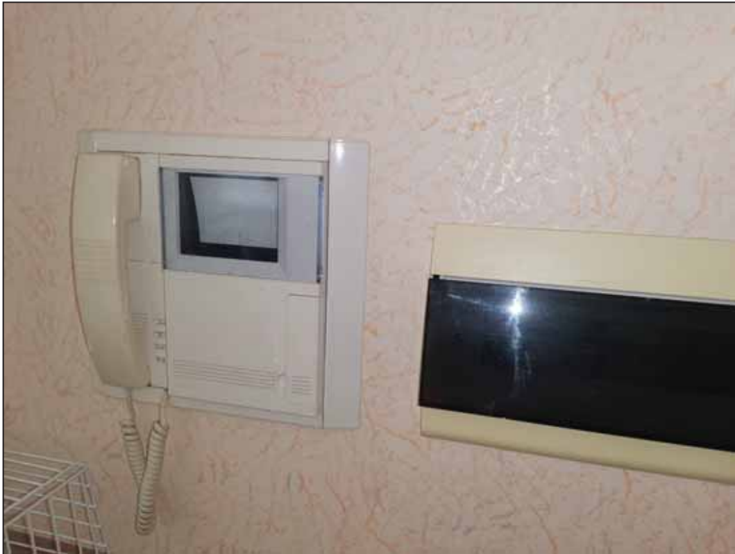
FOTO 69 - Piano secondo – Impianti.
