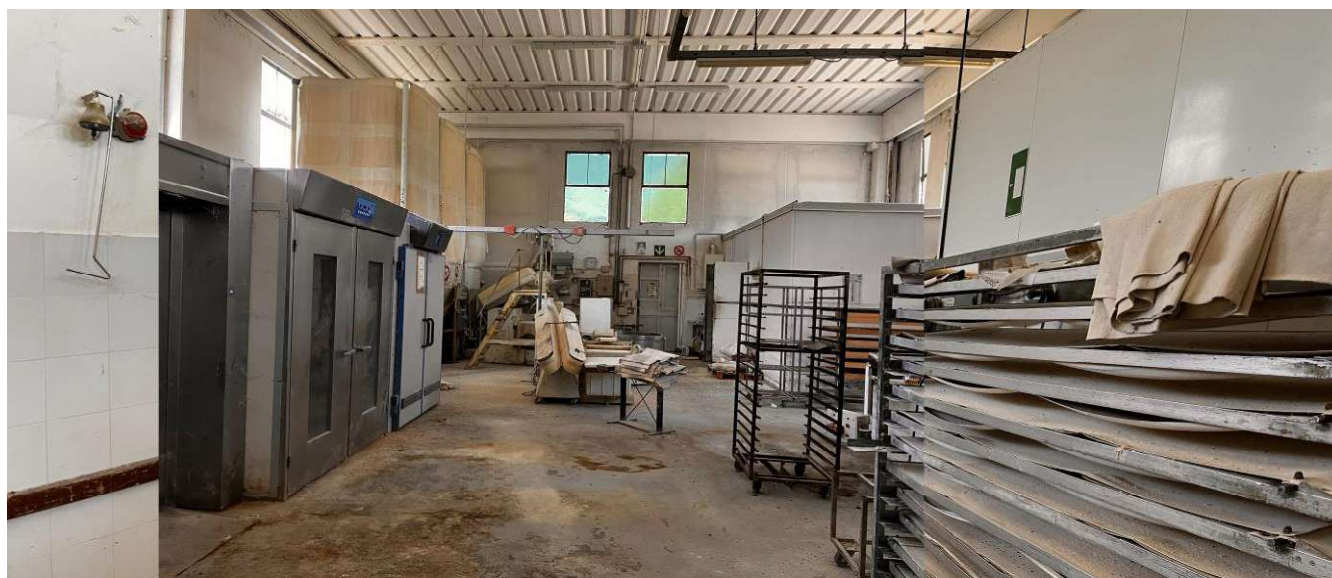
FOTO 07 - OPIFICIO PIANO TERRA - REPARTO FORNI PER PANIFICAZIONE / CELLE LIEVITAZIONE
