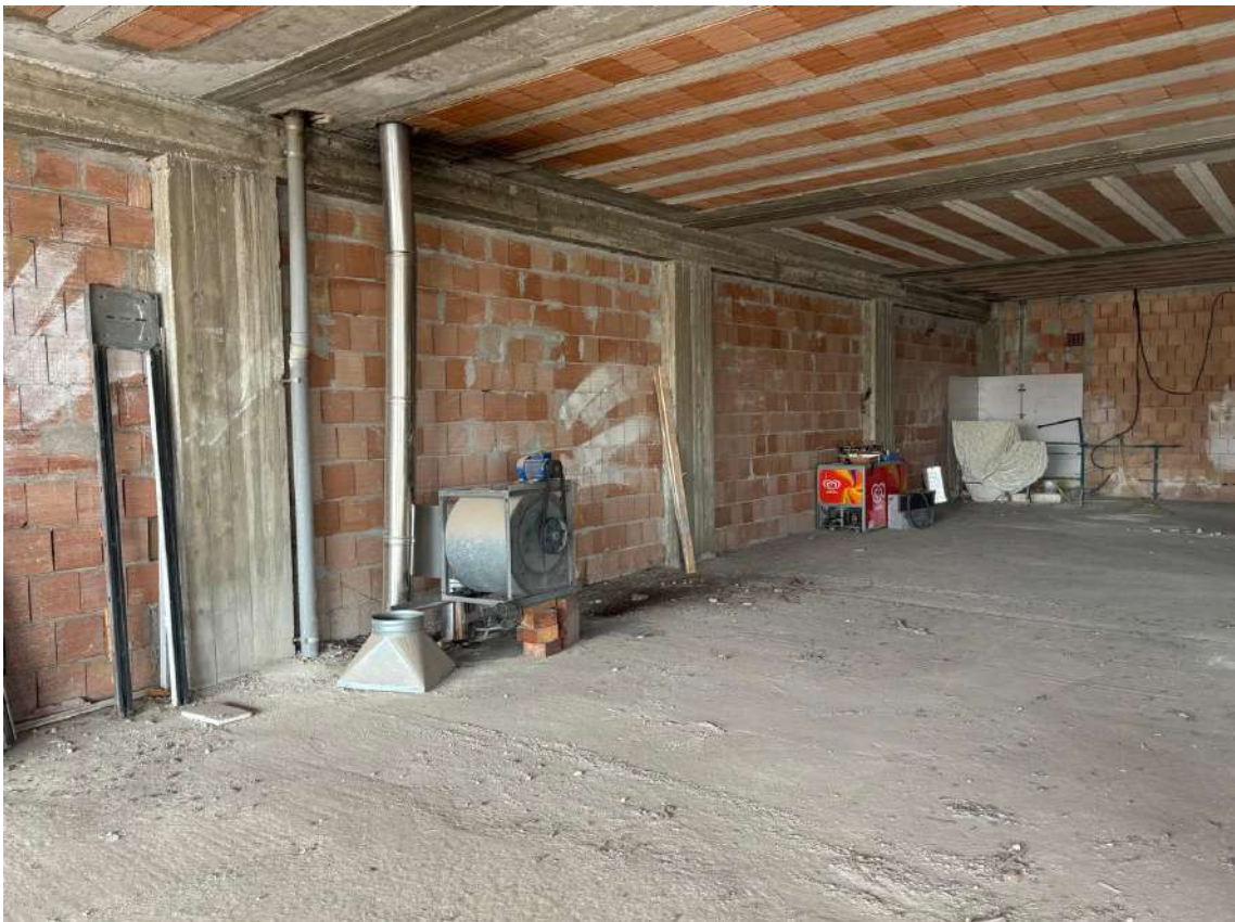
Foto n. 26 – Sub 4, tompagnatura verso il fabbricato adiacente e canna fumaria proveniente dalla sottostante attività commerciale
