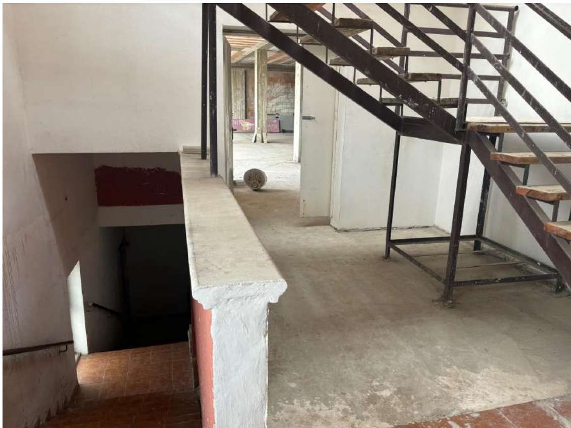
Foto n. 12 – Scala di accesso dal civico 61 di Via Salice e pianerottolo del primo piano
