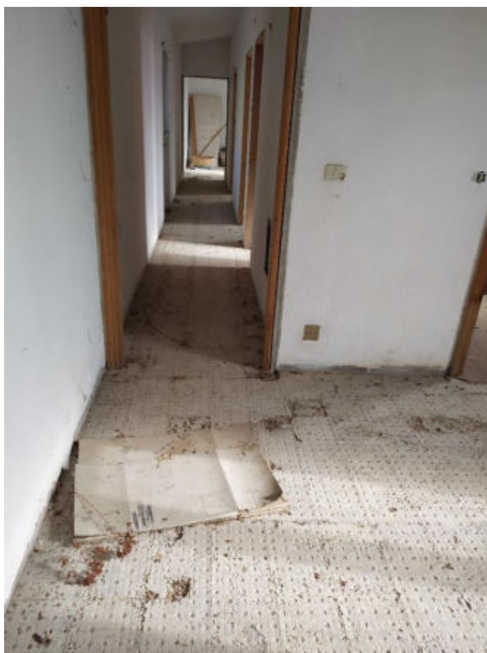
Foto 8 – Pavimentazione mancante soggiorno-corridoio
