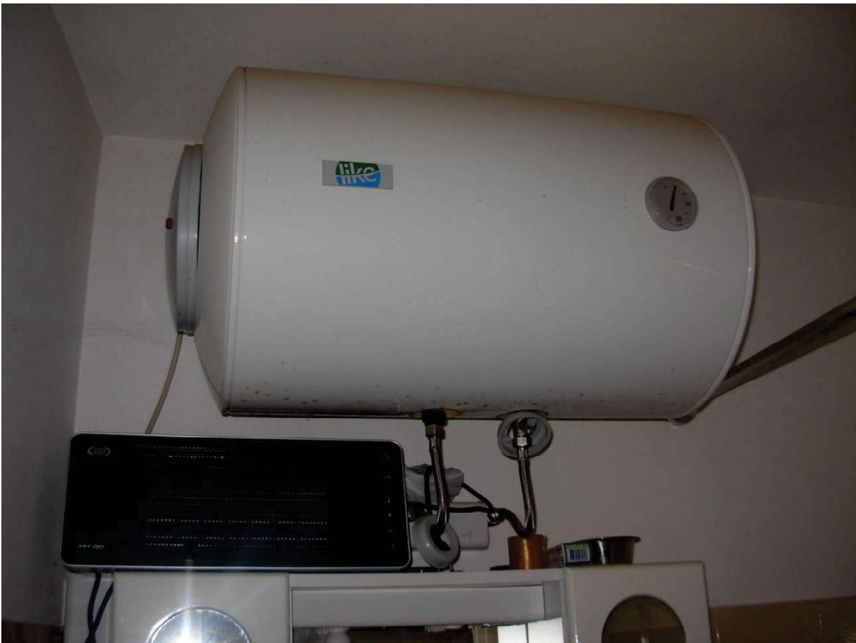
FOTO n. 16 – bagno: scaldacqua elettrico
