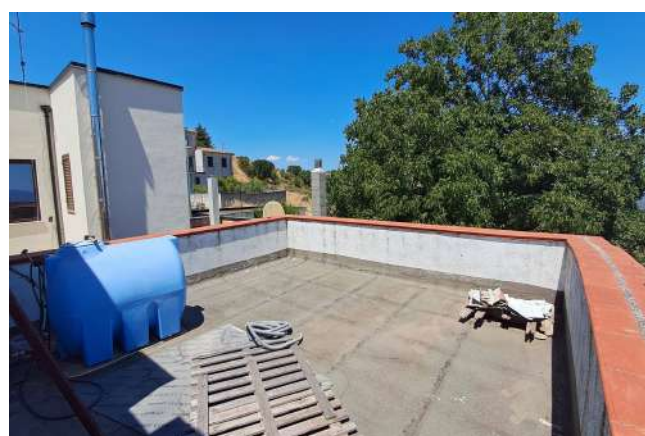
10. Terrazza piano primo. Riserva idrica non in uso.
