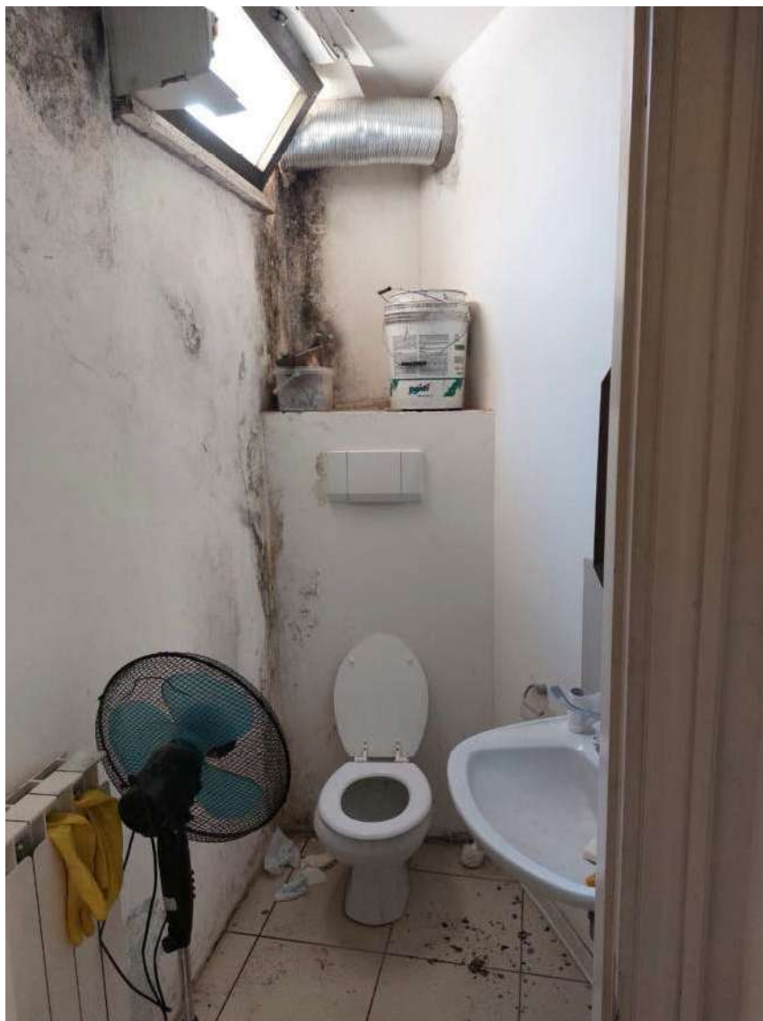
W.C. ZONA LABORATORIO CON INFILTRAZIONI D'ACQUA
