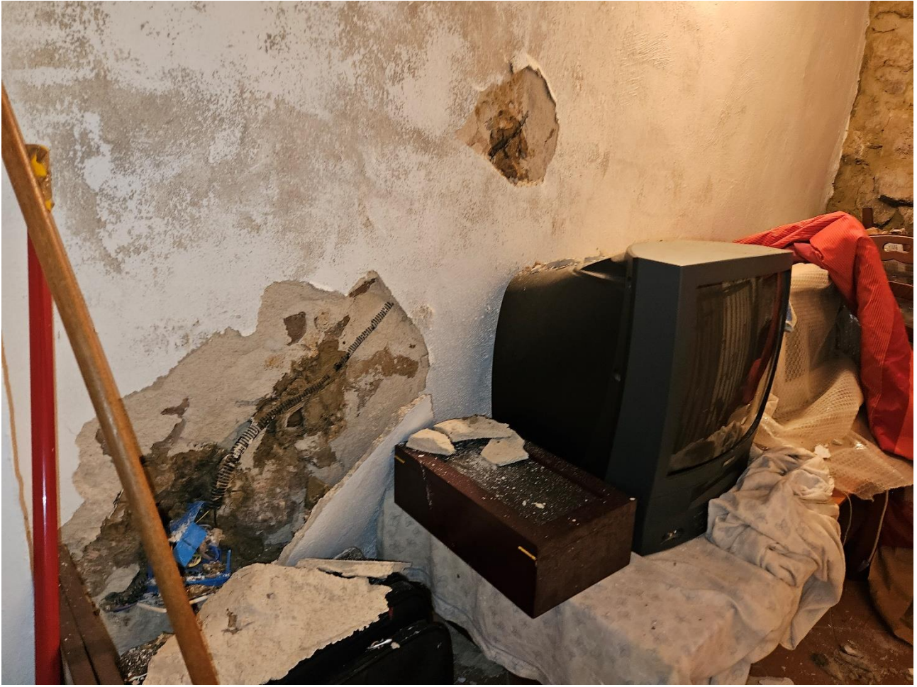
Parete da ripristinare
