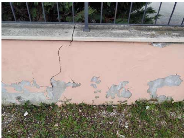
Particolare del degrado del muretto di recinzione
