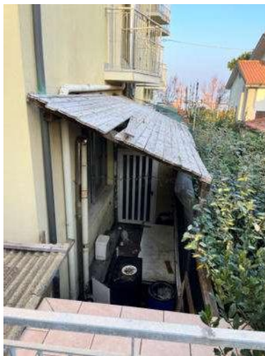
Foto 68: Area urbana con tettoia in legno non legittimata
