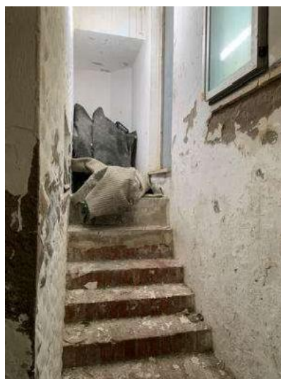
Foto 9: Vano Scale / Accesso PSI
