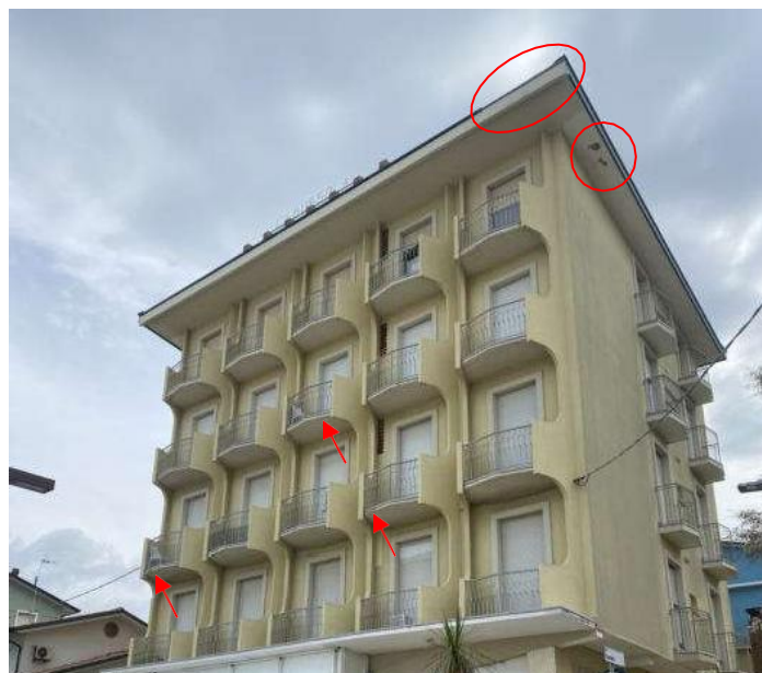
Foto 28: Facciata con scrostamenti intonaco
