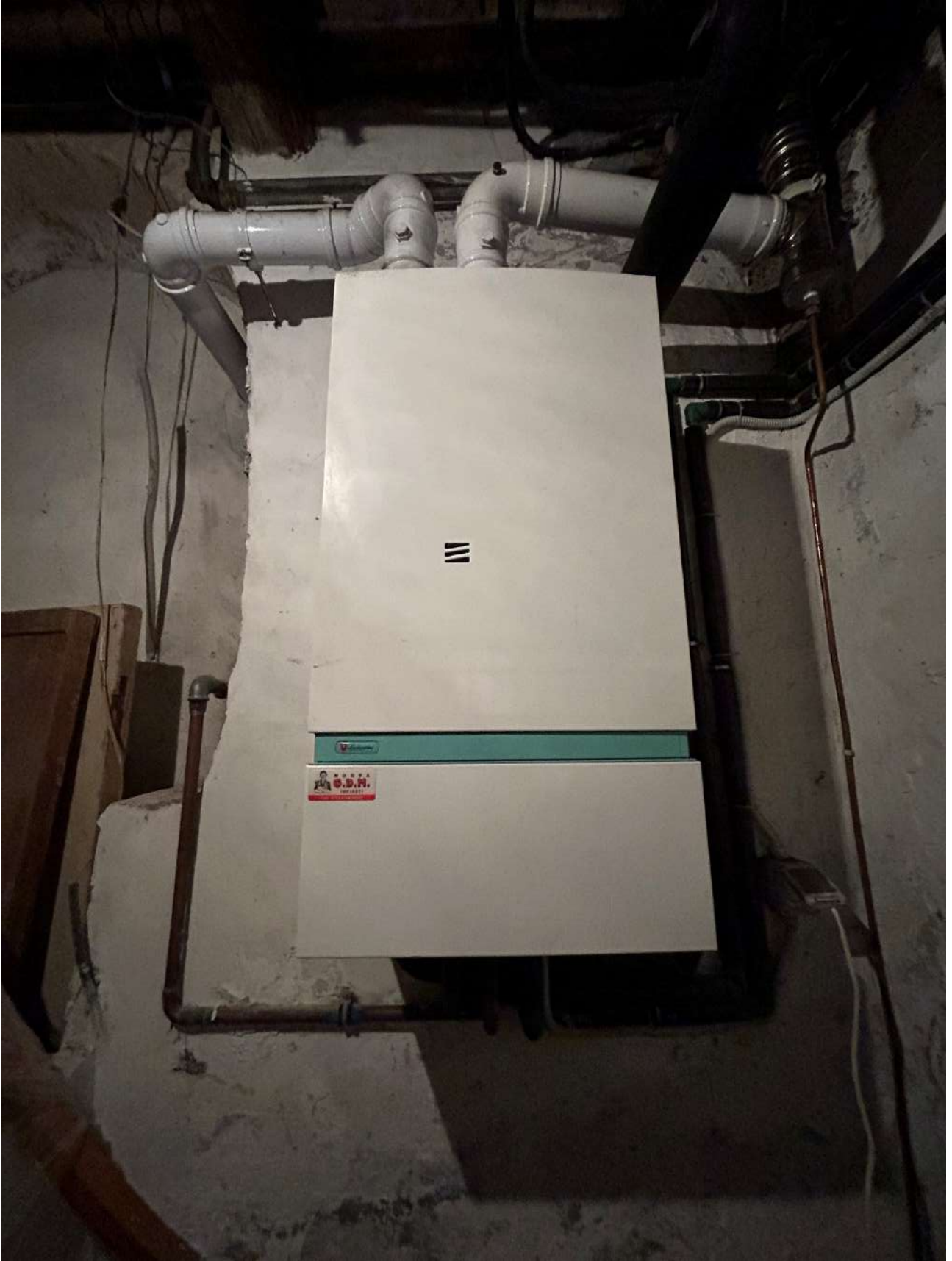
CALDAIA SITUATA NEL SEMINTERRATO
