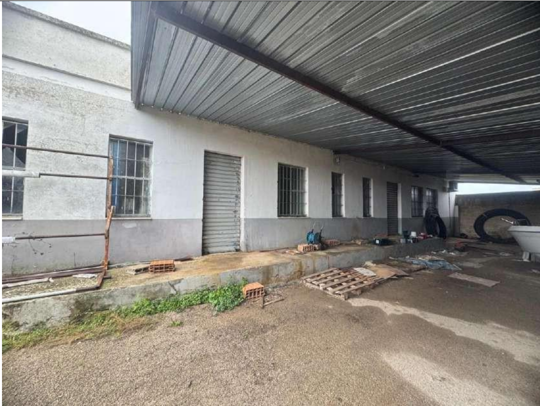
3. Prospetto nord-est e parte della tettoia abusiva
