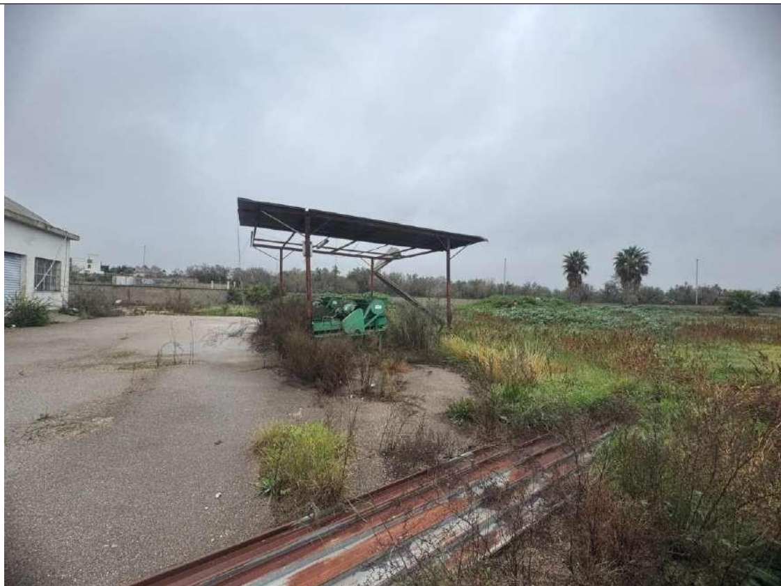
6. Tettoia esterna in stato di degrado a nord-ovest dell'area
