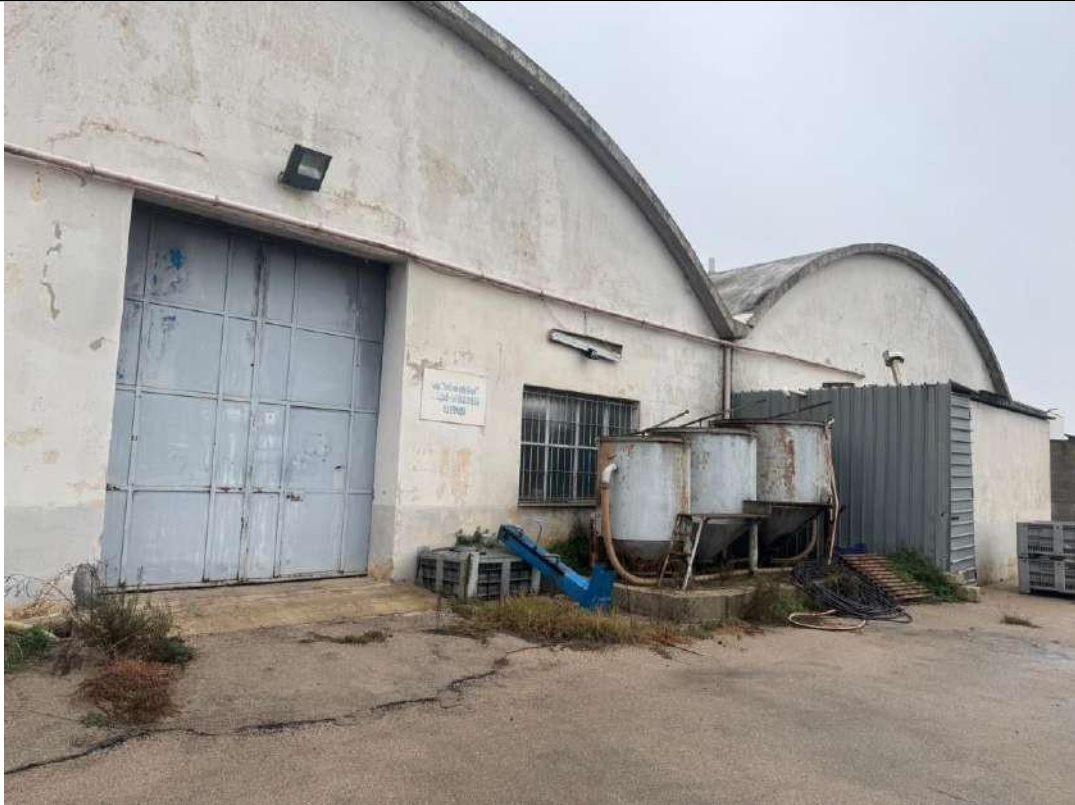
7. Prospetto sud-ovest con volume costruito abusivamente
