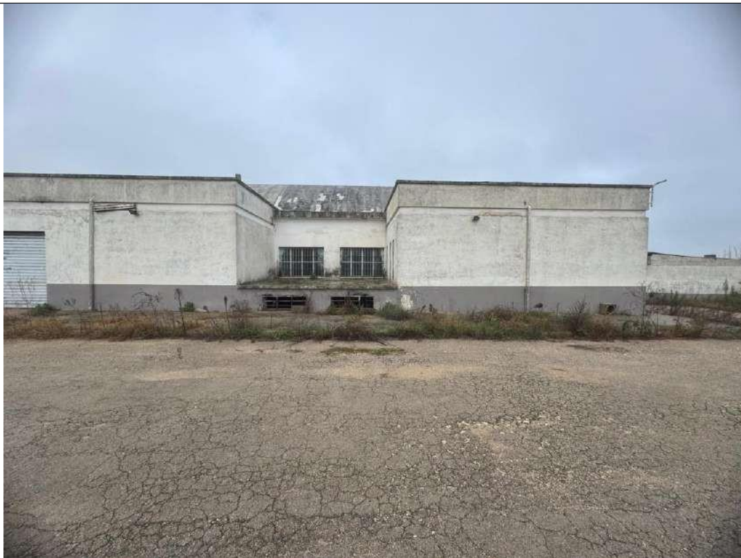
1. Prospetto sud-est e, a destra, parte del muro costruito abusivamente su cui sono appoggiate le tettoie abusive
