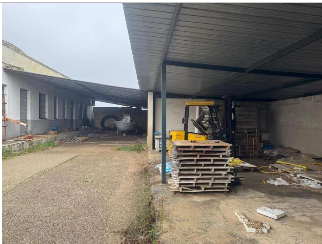
2. Tettoie abusive addossate al prospetto nord-est
