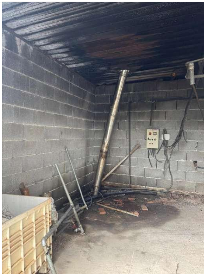
8. Vista interna del volume abusivo coperto da tettoia e addossato al prospetto sud-ovest
