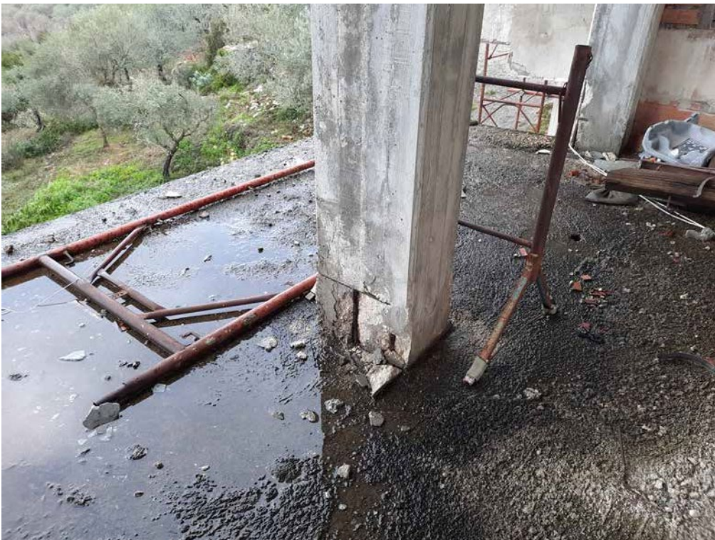
Foto 80: porzione fabbricato non completato, particolare pilastri
