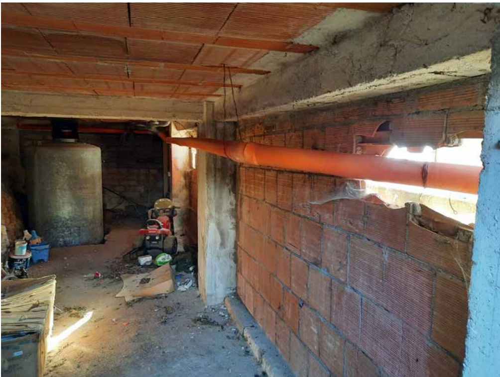
Foto 70: Abitazione D (foglio 27 particella 806 sub 3) – locale autoclave piano 3/S
