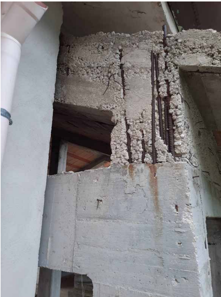
Foto 74: porzione fabbricato non completato, particolare copertura (sub 4) lato ovest
