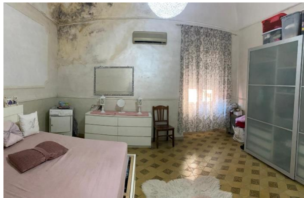
Figura 19- Infiltrazioni solaio soggiorno-cucina
