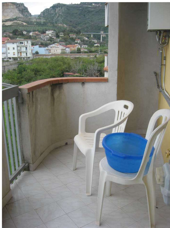
Foto N° 6 Unità immobiliare in Via Tasca 26– Fl 8 part.Ila 155 sub 25 - Balcone
