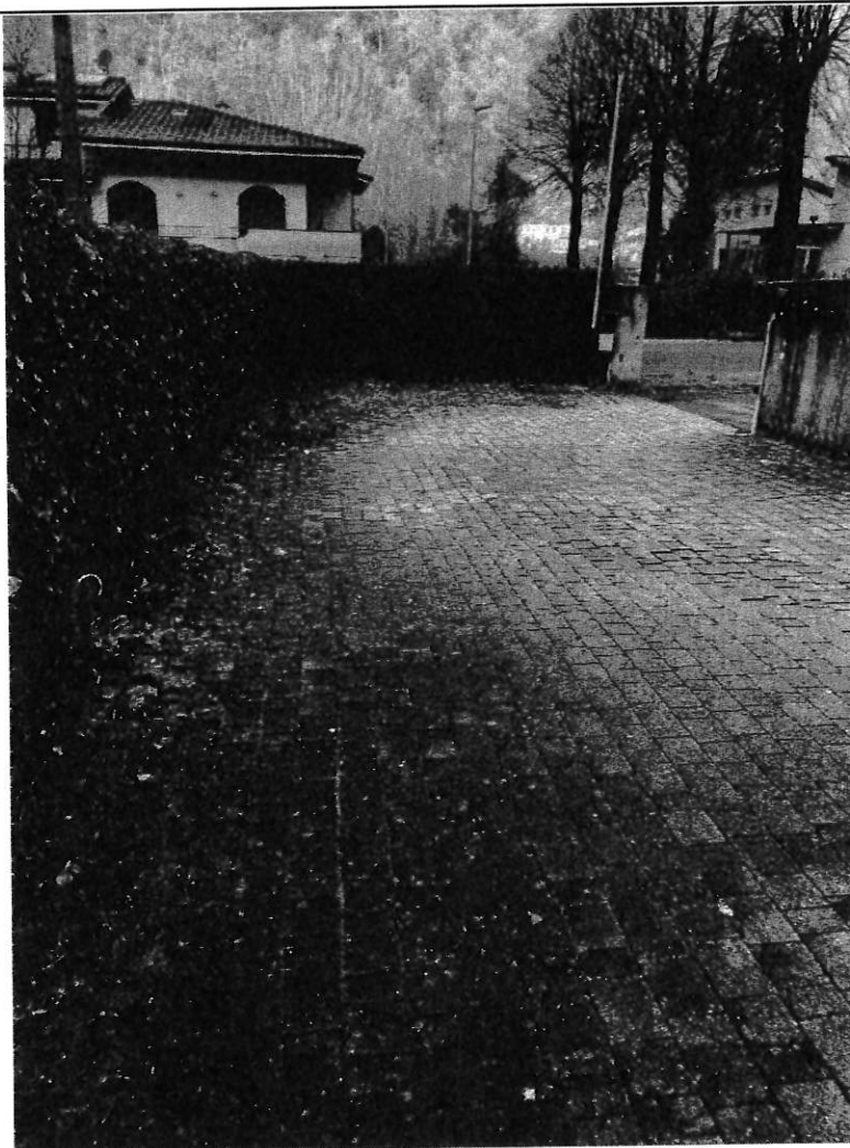
Foto 20 – piazzale condominiale zona ingresso dal parcheggio pubblico ove è posta una sbarra attualmente non funzionante – porzione del sub. 7
