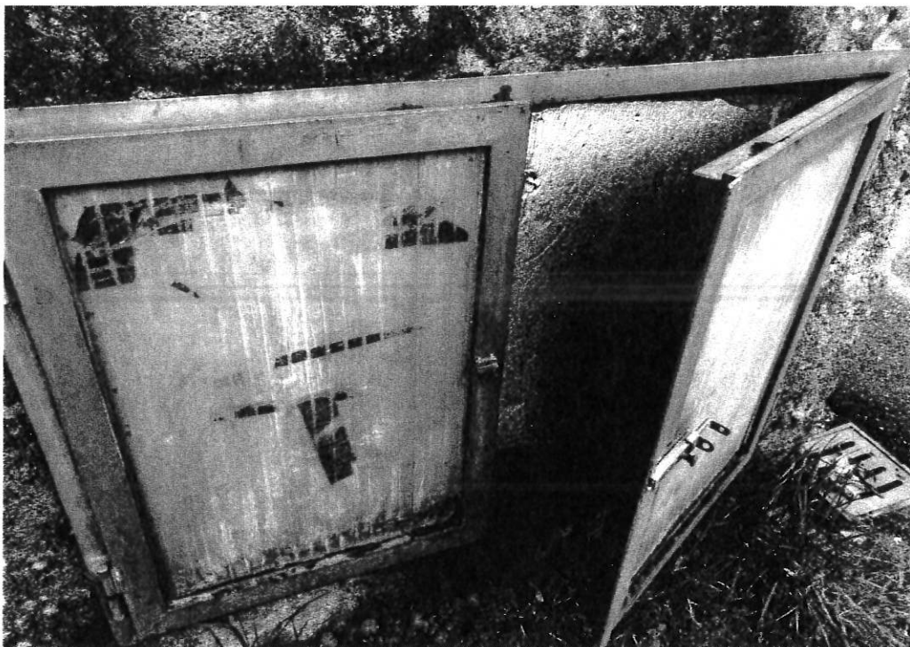
Foto 28 – vano dei contatori dell'acquedotto posto all'esterno nel muro di confine sul lato destro dell'ingresso dal parcheggio pubblico a confine con la pubblica via
