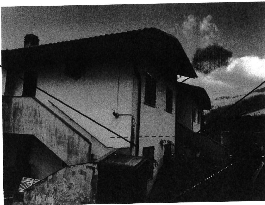
Foto 7 – Lato Ovest –vista finestre delle camere – lato sud con affaccio sulla porzione di resede di proprietà di terzi (sub. 6)
