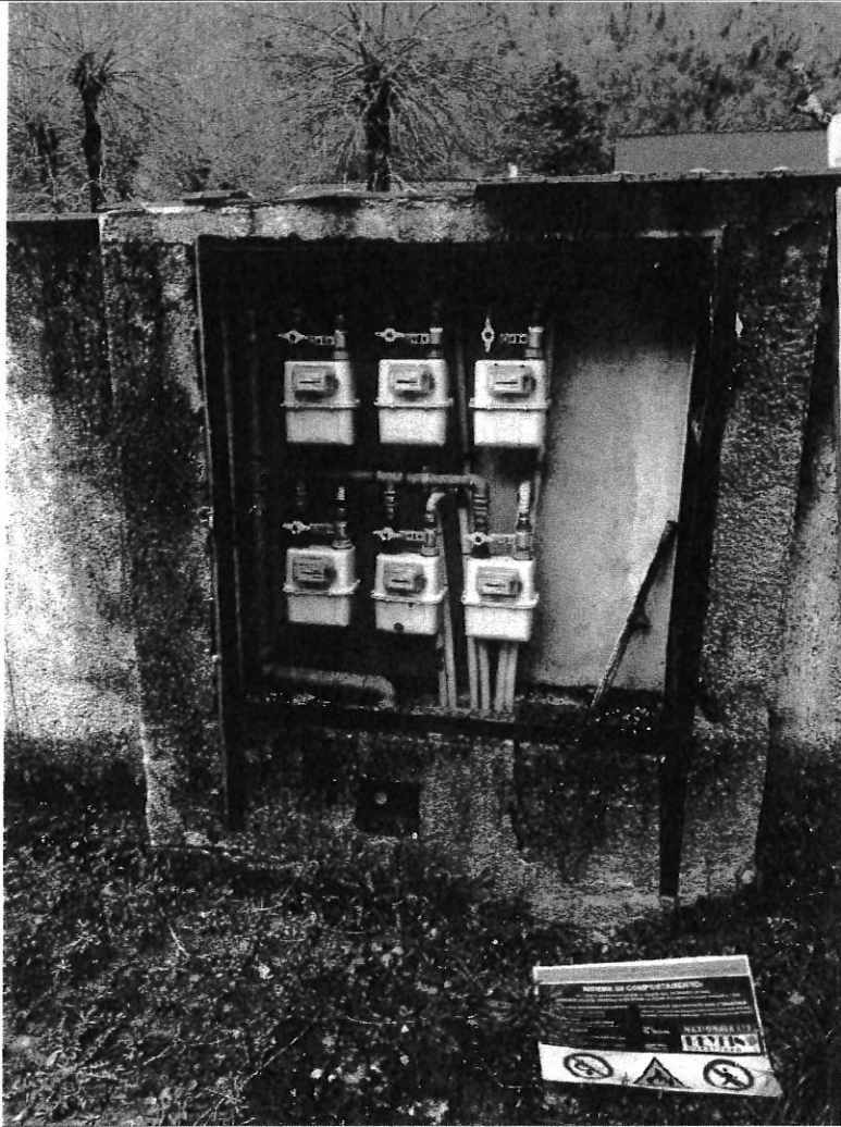
Foto 26 – vano dei contatori del gas gpl nel muro lato nord dalla parte interna del condominio a confine con il parcheggio pubblico
