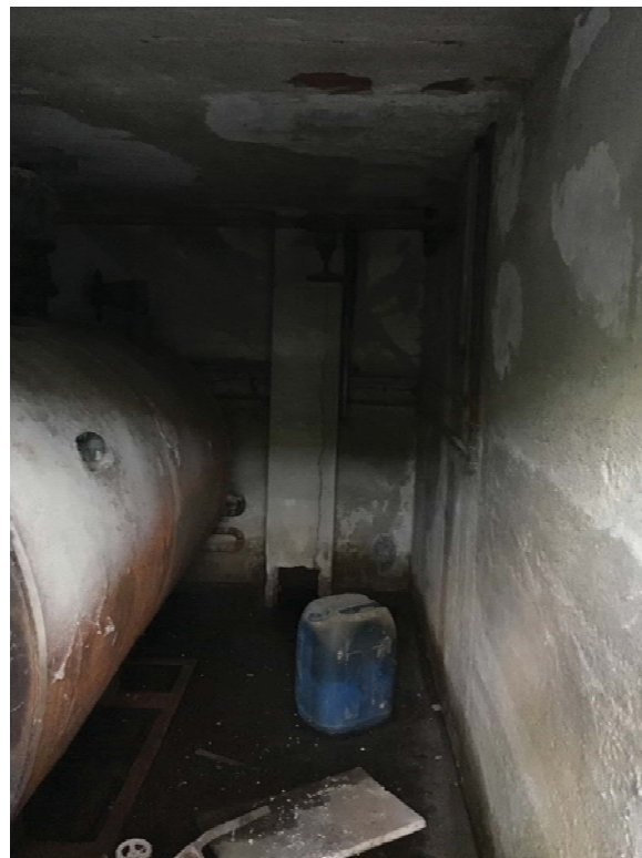
Fig. 11 – Particolare Sub 3 – Locale caldaia
