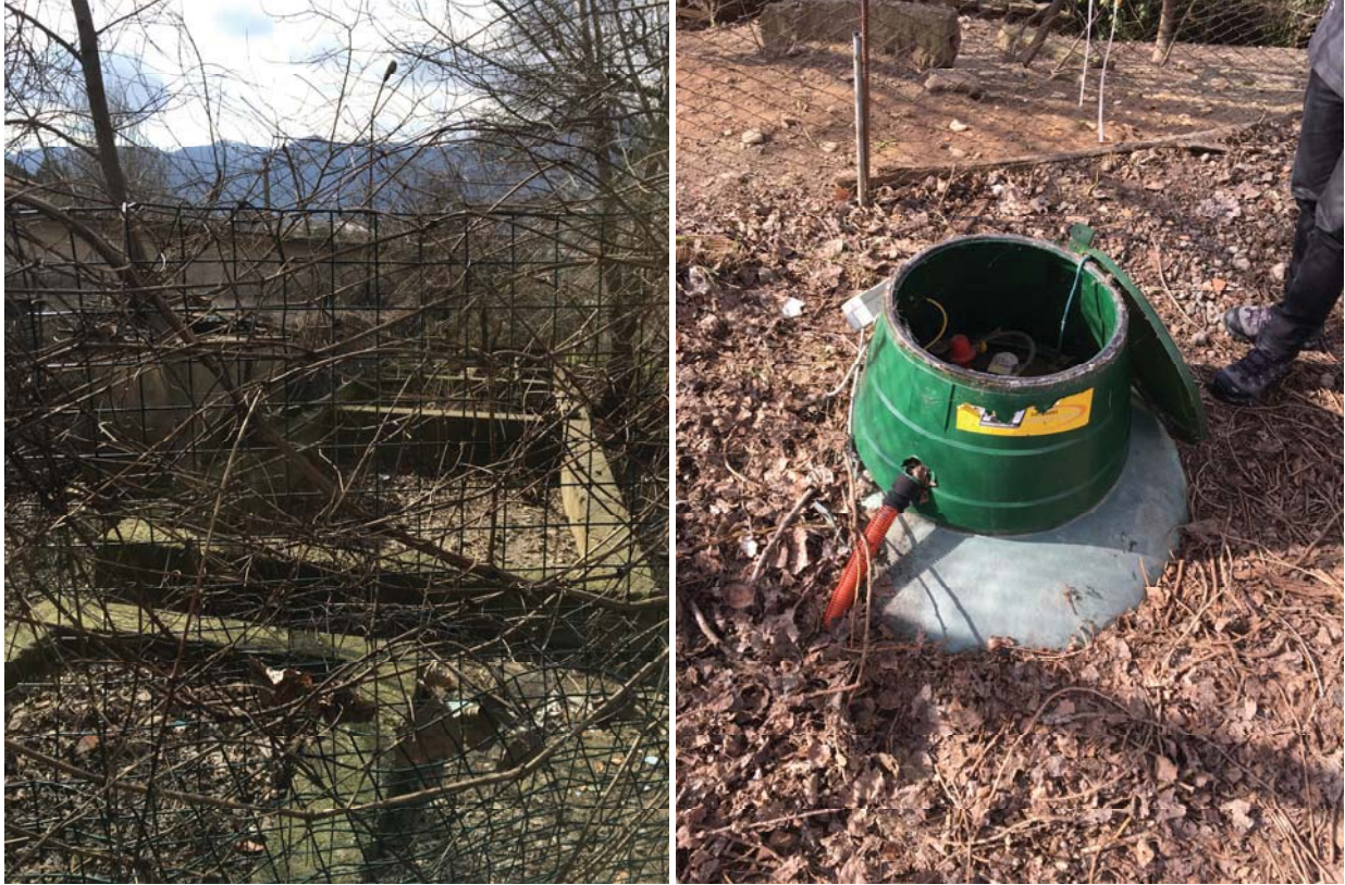
Fig. 12 – Vasche e strumentazione esterna
