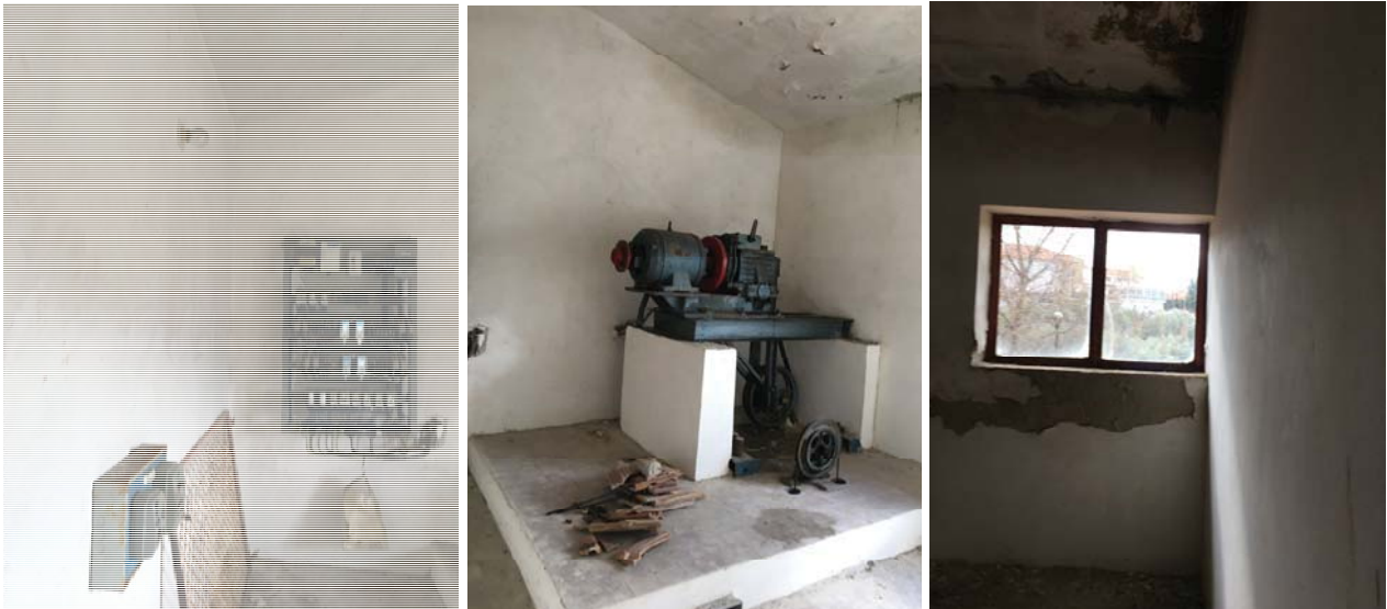
Fig. 11 – Foto degli interni - Locale tecnico elevatore
