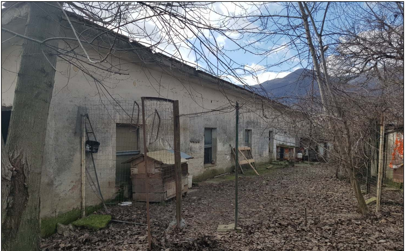
Fig. 21 – Immagine del prospetto principale della stalla difforme da quello previsto in progetto
