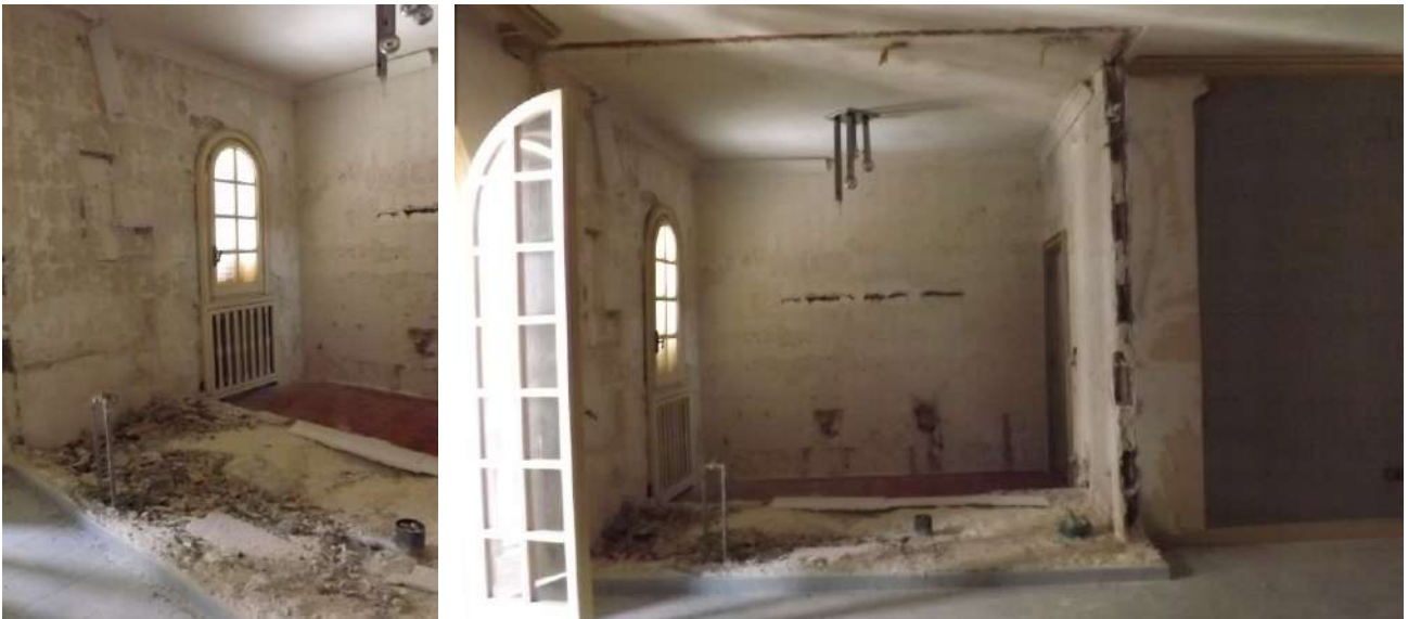
Foto 69-70_Viste d’insieme dell’originario bagno/WC adiacente al salone: vano oggi dismesso con finiture e sanitari asportati; scassi e predisposizioni idrico-sanitarie a vista, tratti di sottofondo demoliti e murature ammalorate/rappezzate.
