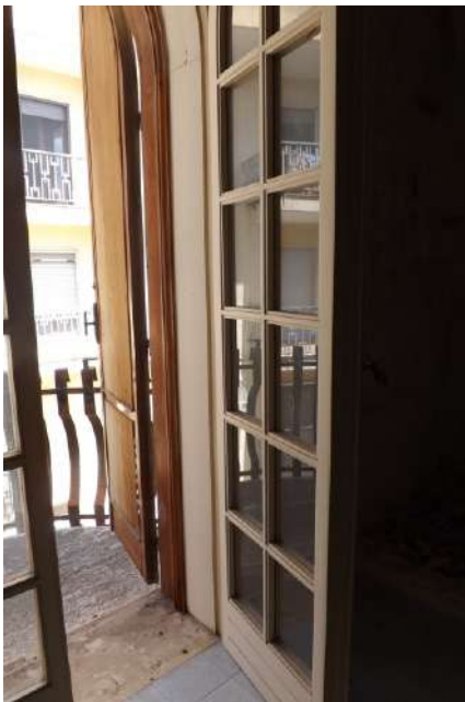
Foto 71_ Porta-finestra del salone verso il balcone: serramento in legno con ante vetrate e persiane, finitura
