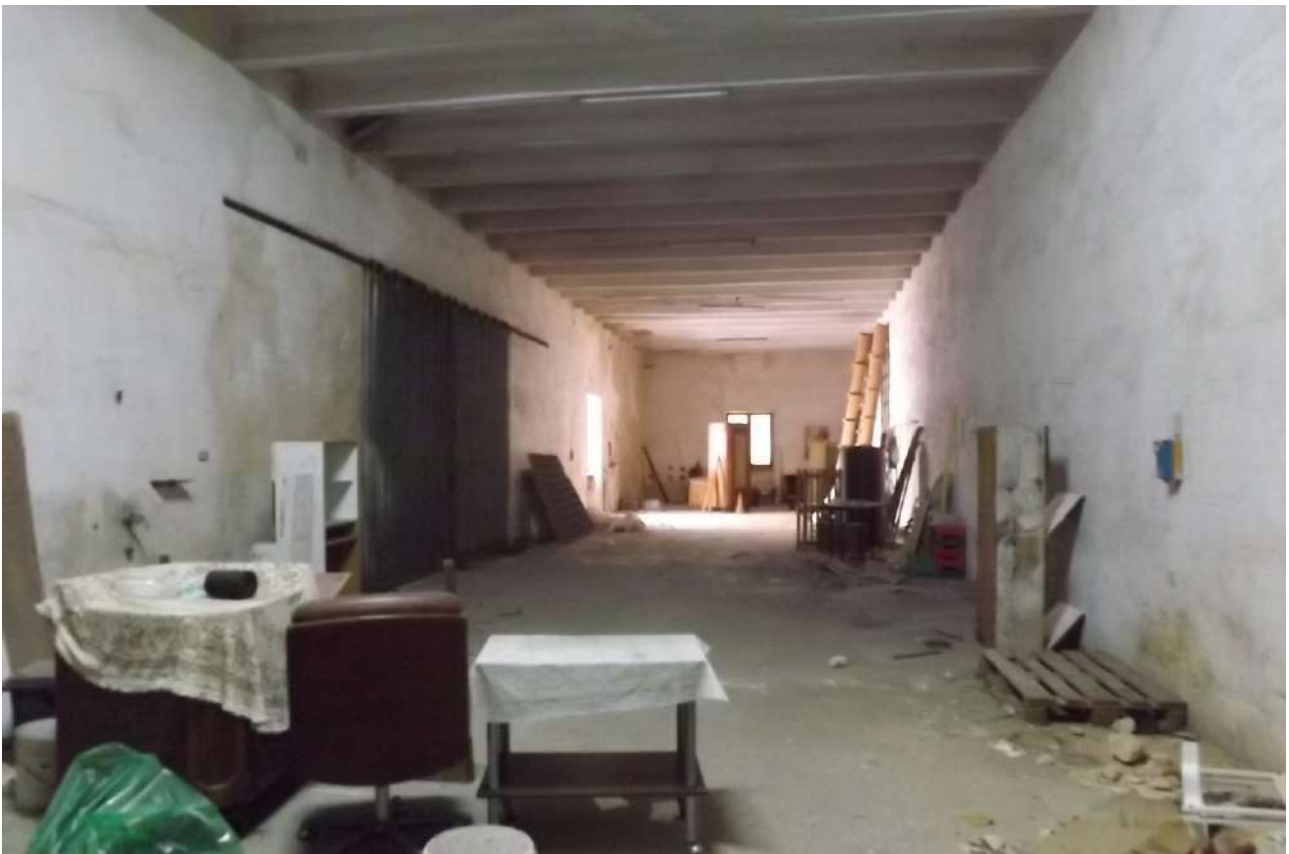
Foto 28_Vista d’insieme del locale deposito: ambiente a navata unica, profondo e privo di partizioni, con solaio in travi a vista (c.a.) e pavimentazione in calcestruzzo grezzo; pareti intonacate con aloni di umidità, annerimenti e locali distacchi; impianti e canalizzazioni a vista, plafoniere lineari al soffitto, chiusura scorrevole sul lato sinistro; presenza di materiali e attrezzature accatastati e tracce di polveri/detriti sul piano di calpestio.
