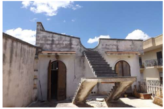
Foto 92_ Vista d’insieme del prospetto noed-est dell’abitazione con la scala esterna in calcestruzzo che conduce al lastrico solare, realizzata in assenza di titolo edilizio.
