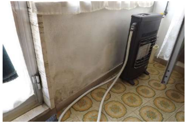
Foto 19_ Vista del nodo parete-battiscopa vicino al serramento: degrado delle finiture per umidità con aloni e micro-distacchi.
