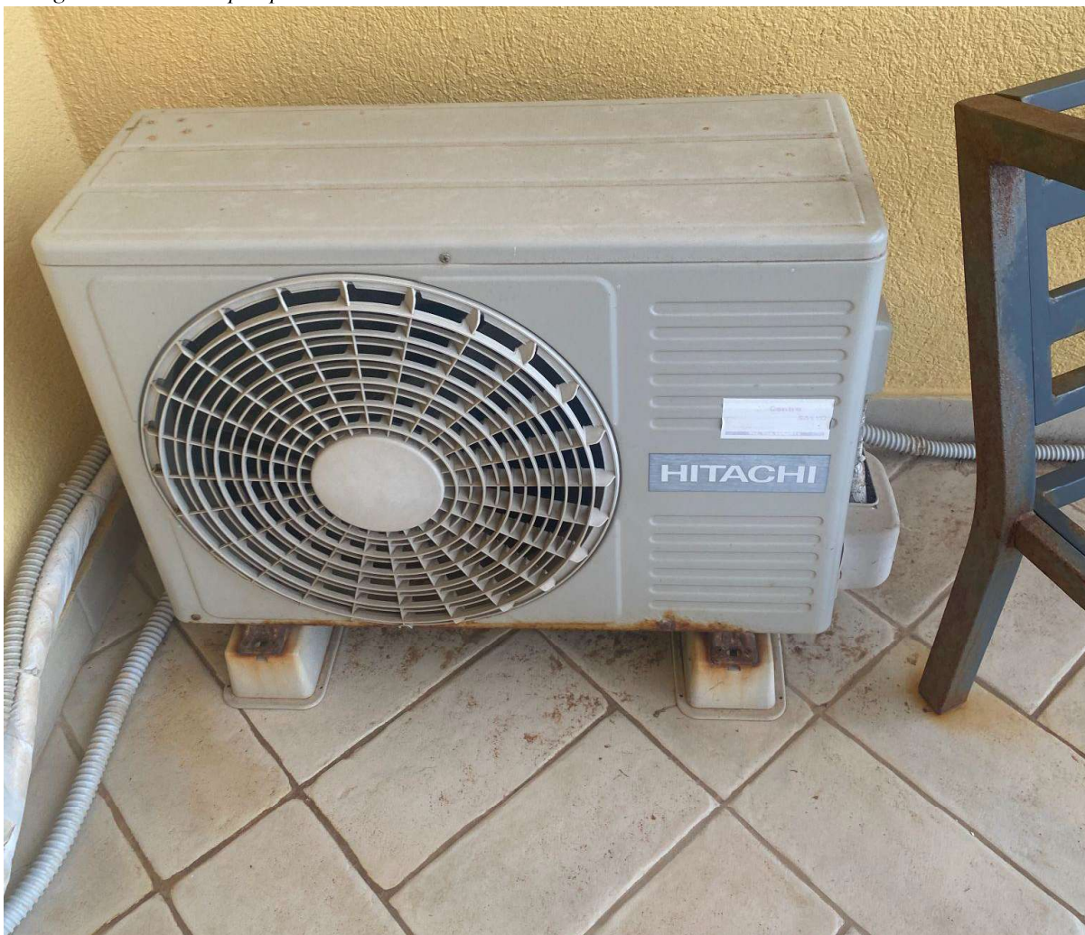
Dettaglio unità esterna pompa di calore e centralino elettrico residenziale
