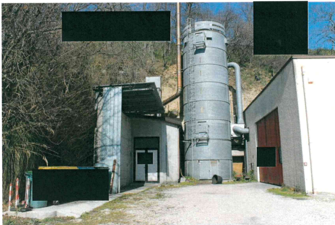
FOTO 5: Silos impianto di aspirazione con locale tecnico
