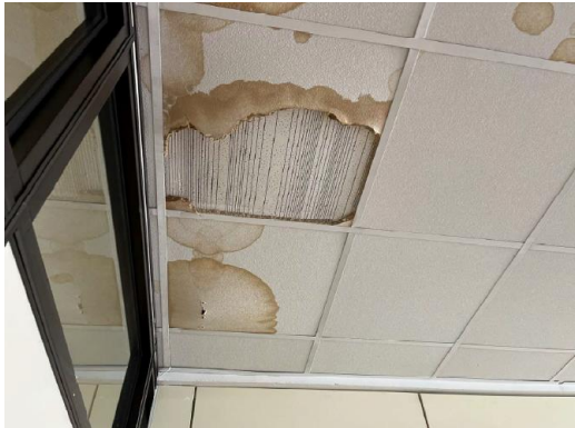
Figura 5 - DETTAGLIO DANNI DA INFILTRAZIONE
