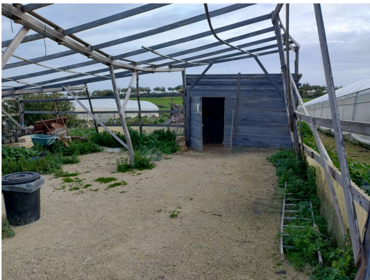
Foto 12 e 13 – Strutture precarie.
