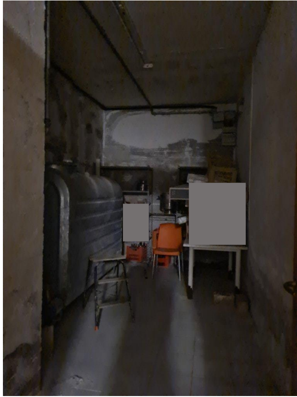
35. Vista del locale centrale idrica al piano primo sottostrada
