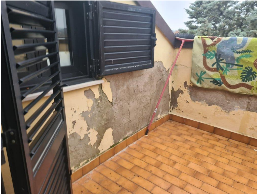
31. Vista delle zone ammalorate dei balconi al piano secondo
