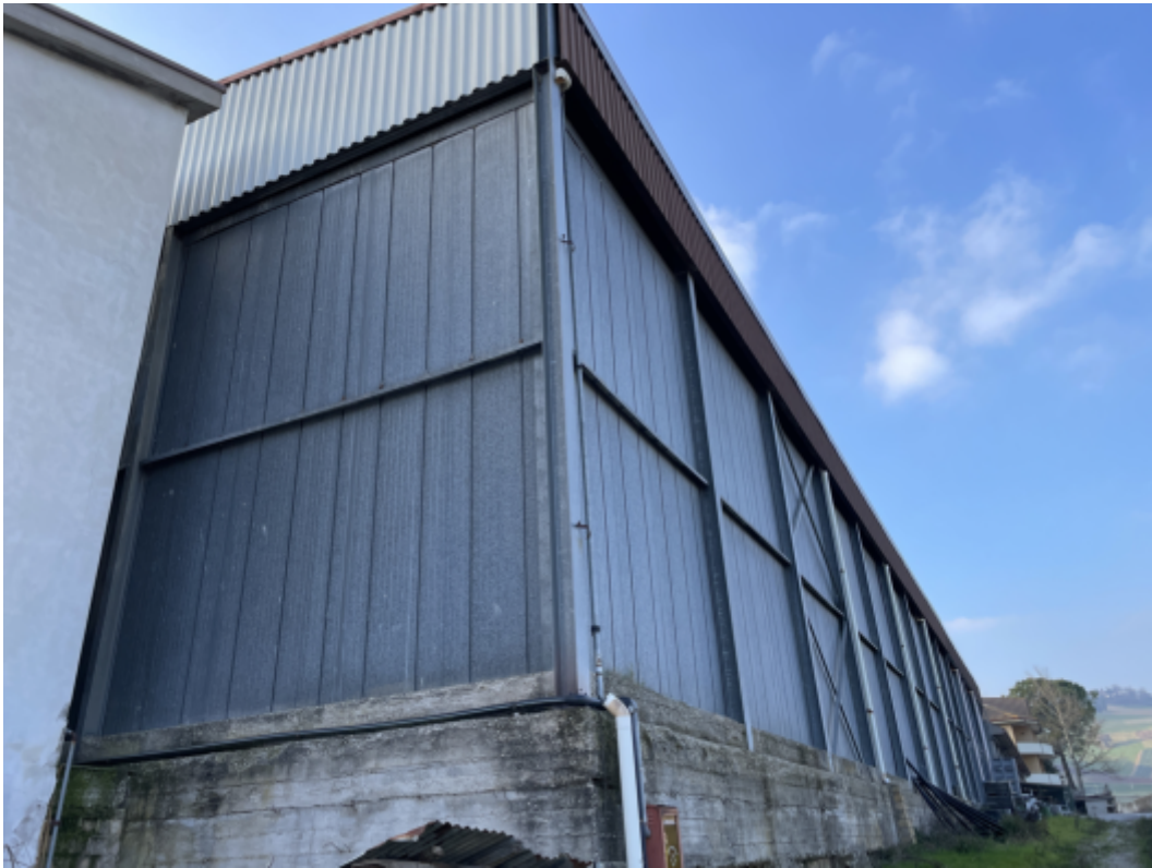
Foto n.19 (celle frigorifere vista lato est)
