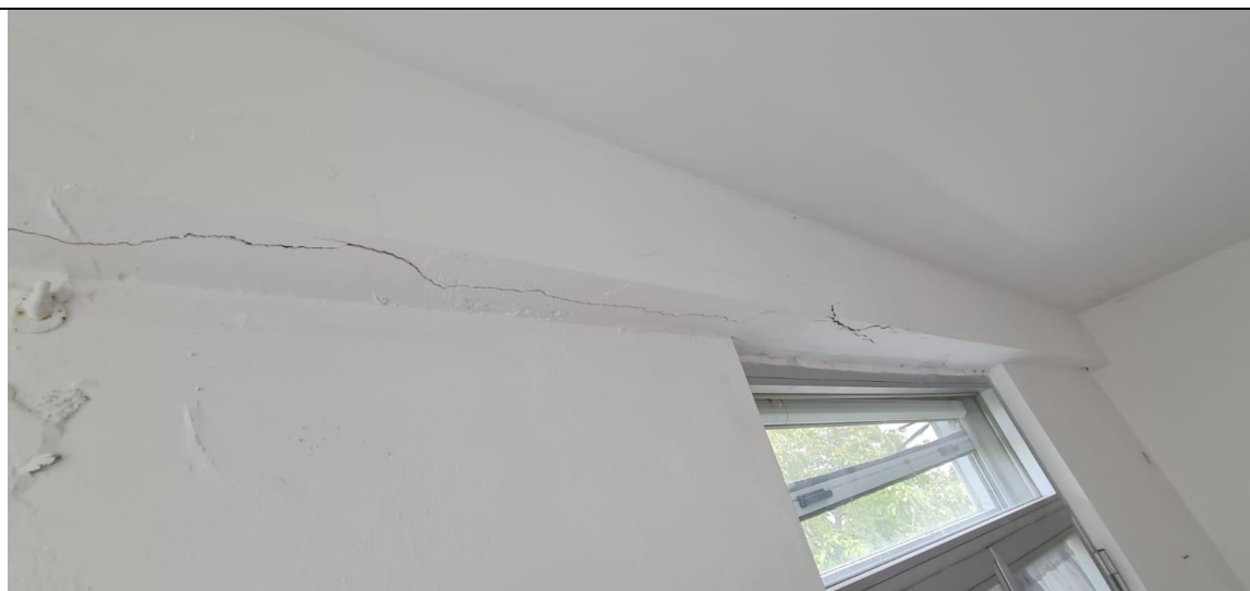
Danno da infiltrazione con conseguente deterioramento del c.a. della trave Est, all'interno del locale "st"
