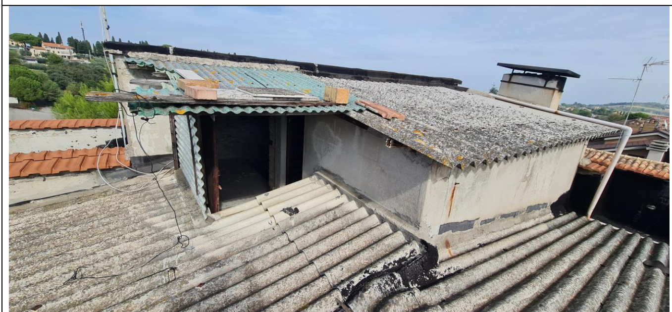
Manufatto in copertura costituito da lastre del tipo "onduline", in materiale cementizio
