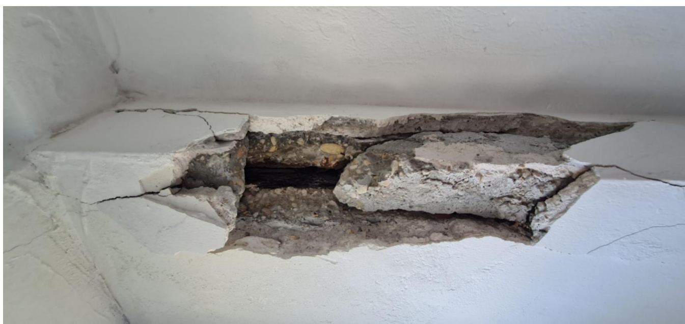
Infiltrazione d'acqua nel soffitto del locale "st", con conseguente deterioramento calcestruzzo e corrosione
