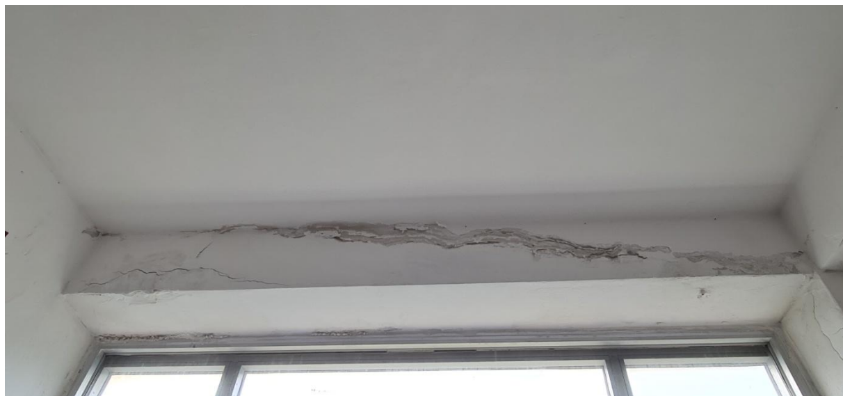
Danno da infiltrazione con conseguente deterioramento del c.a. della trave Nord, all'interno del locale "st"
