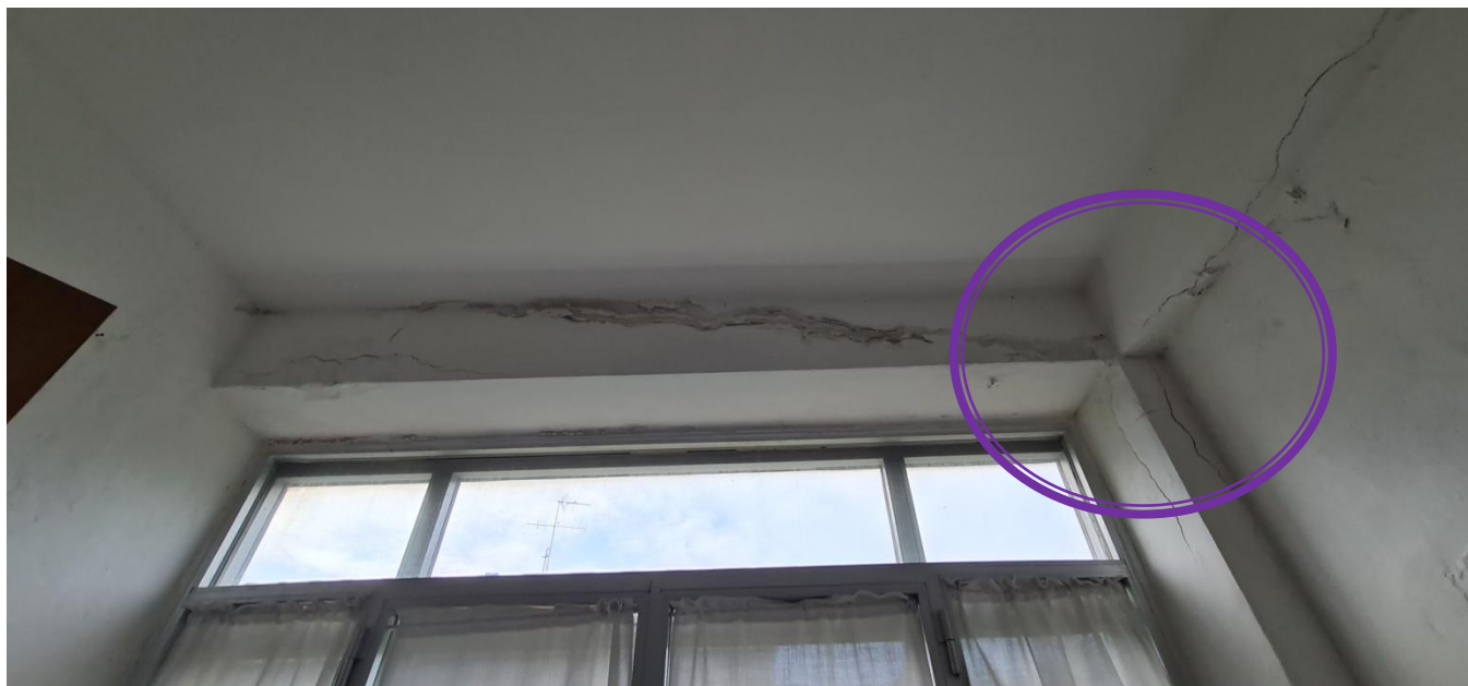
Infiltrazione al NODO STRUTTURALE Nord-Est, al livello secondo
