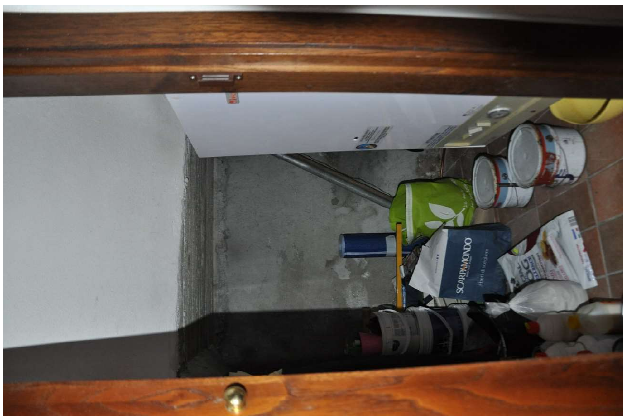
FOTO 8 PIANO I° SOTT. LIVELLO INGRESSO – LOCALE TECNICO
